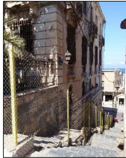
Figure 69 : Périmètre de sécurité installé autour de l'ancien siège de la BA qui menace ruine (Auteur)
