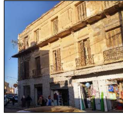
Figure 16 : bâtiment résidentiel en mauvais état, maintenu par la présence de commerces au RDC (Auteur)
