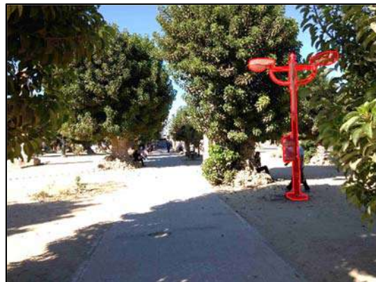
Figure 77 : Lampadaire avec crose d'autoroute à remplacer (Auteur)
