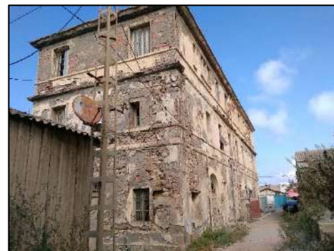
Figure 70 : Ancien siège des douanes, état de dégradation avancée due à l'absence d'entretien (Auteur)
