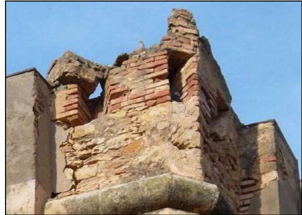
Photo 4.43 : Composition hétérogène du parapet
