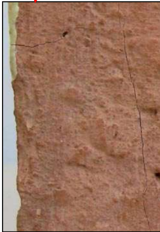
Photo 4.60 : Fissure longitudinale et une autre transversale
