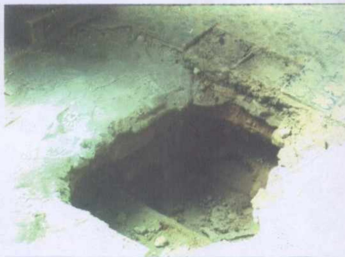
FIGURE 441 : SONDAGE EFFECTUE AU NIVEAU DU SOL DE L'ESPACE SUPERIEUR POUR VERIFIER L'ETAT DE DEGRADATION DES SOLIVES ET VOLIGES.
