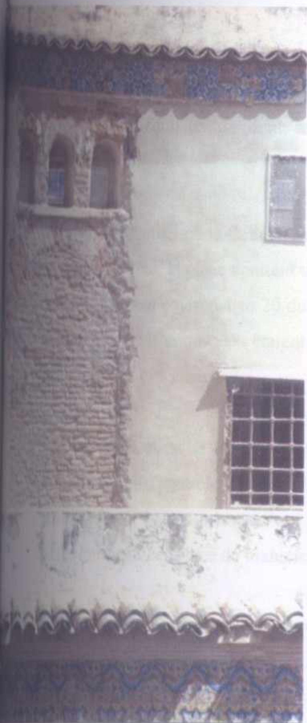
FIGURE 360 : BAIE ENCORE OBSTRUEE MONTRANT DES TRACES DE L'ANCIENNE OUVERTURE.
