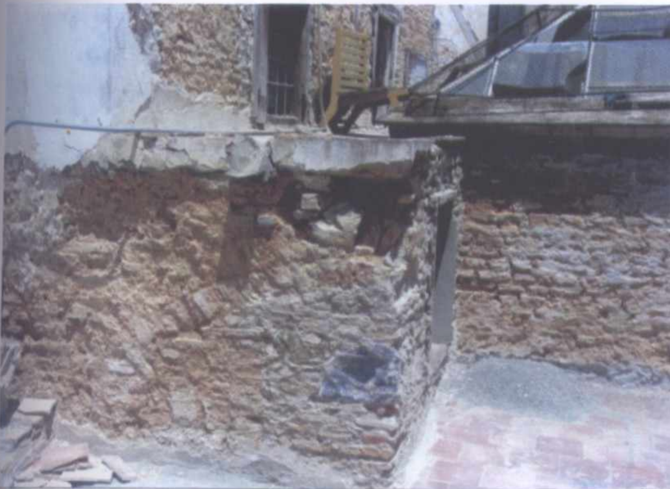
FIGURE 371 : PERTURBATION A L'EXTREMITE DROITE DU MUR DE L'ALLEE EN TERRASSE [Gal no 301]. (Cliché personnel).
