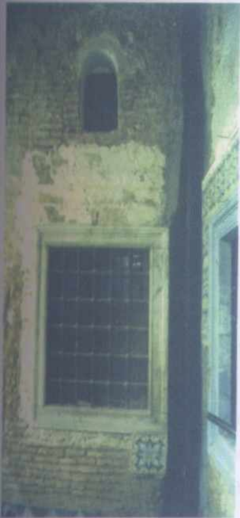
FIGURE 343 : PERTURBATIONS AU NIVEAU D'UNE FENETRE SUR LA GALERIE [Gal ne 201].
