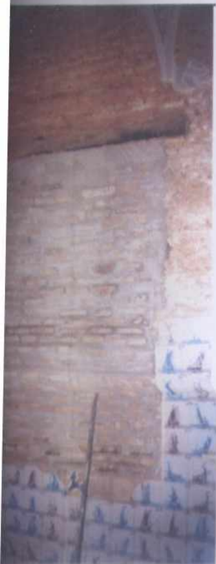
fenêtre sur rue, datant coloniale, re-obstruée.
