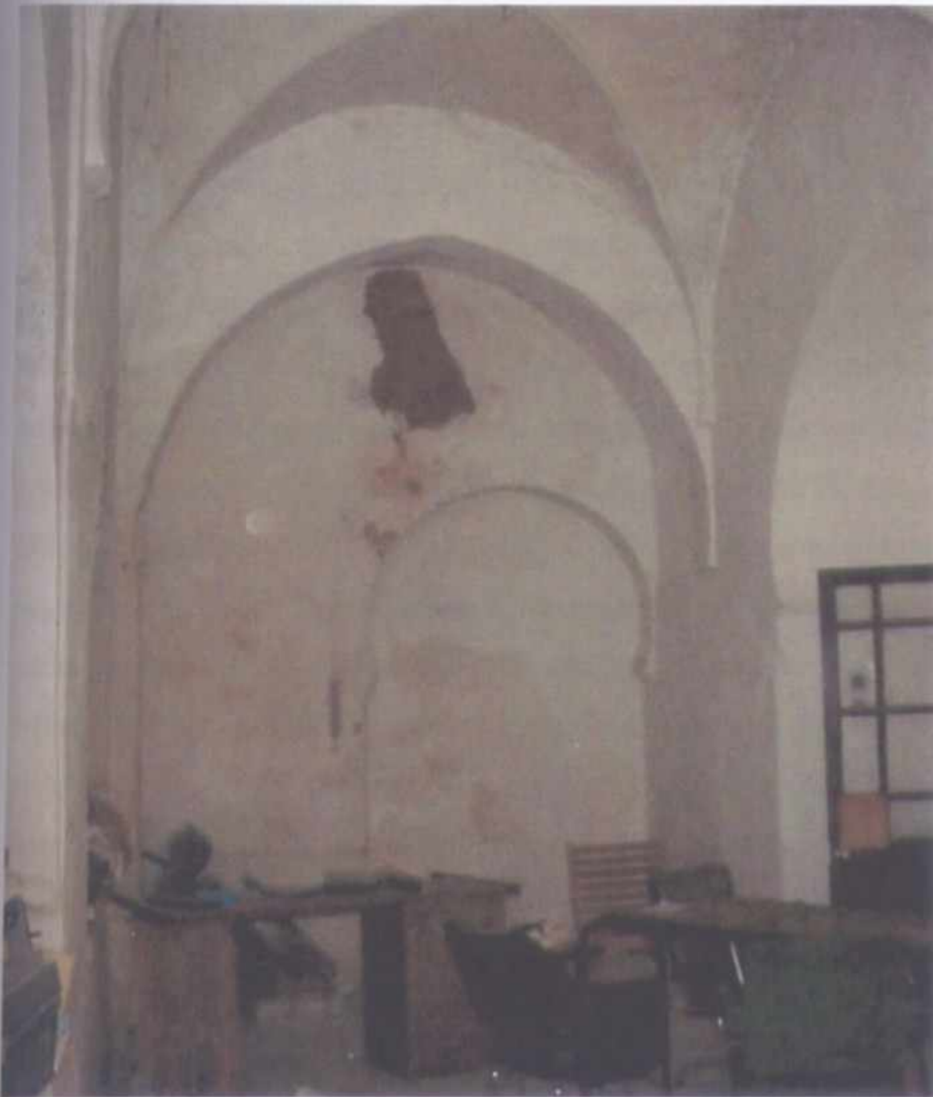
FIGURE 419 : DEFONCEMENT ARQUE REVELANT LA FORME DE LA BAIE REALISEE DURANT LA PERIODE COLONIALE POUR CREER UNE CONTINUITÉ SPATIALE ENTRE LA BUANDERIE [P so 102] ET LA PIECE [P so 101].
