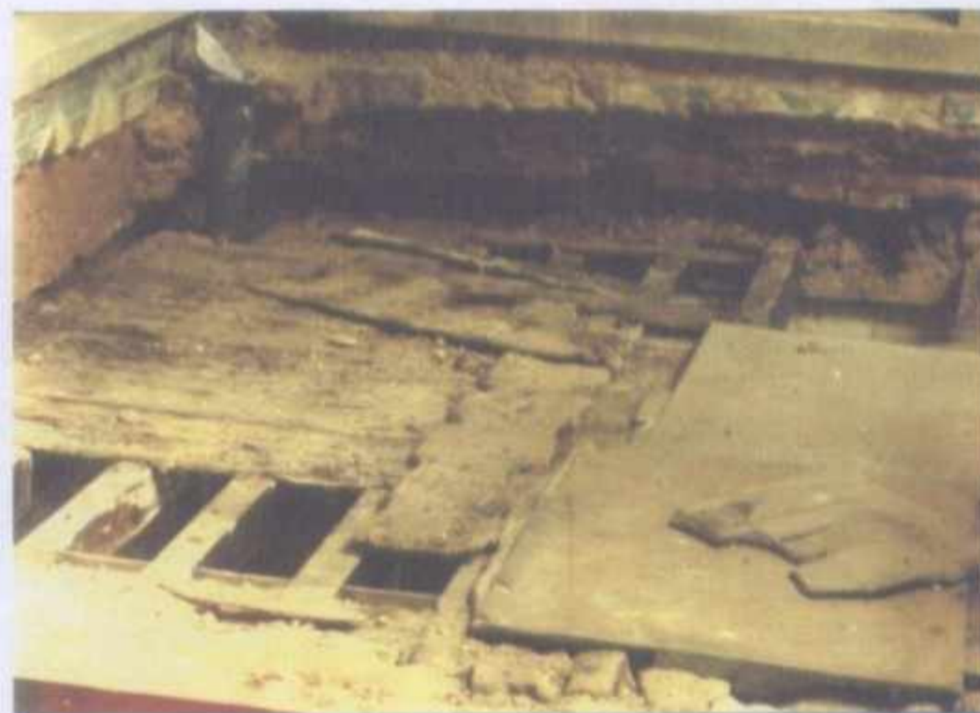
FIGURE 442 : ETAT DE DETERIORATION DES SOLIVES ET VOLIGES.
