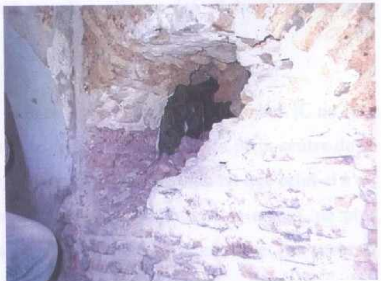
FIGURE 390 : DECOUVERTE D'UNE EXCAVATION DANS LE MUR LATERAL DE LA SECONDE VOLEE.
