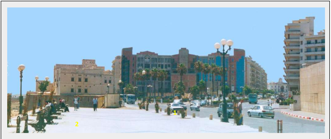
Photographie montrant le projet du futur conservatoire d’Alger (1) en cours de construction, qui s’implante selon une disposition symétrique par rapport à l’axe de la perspective prise à partir de l’esplanade Bab El Oued.
