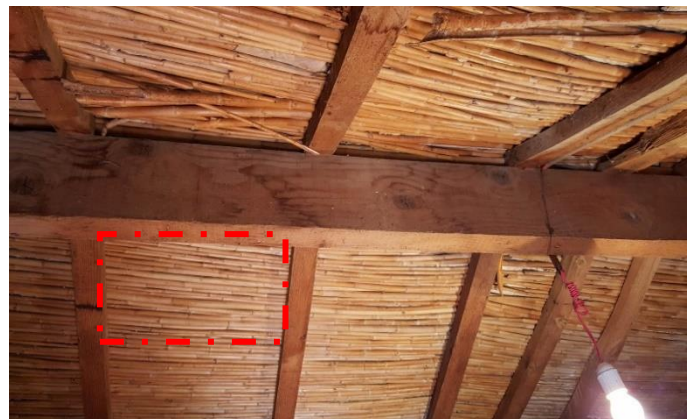
Figure 64: : Photo représentant les roseaux de la toiture dans la pièce des provisions, (source : auteur)
