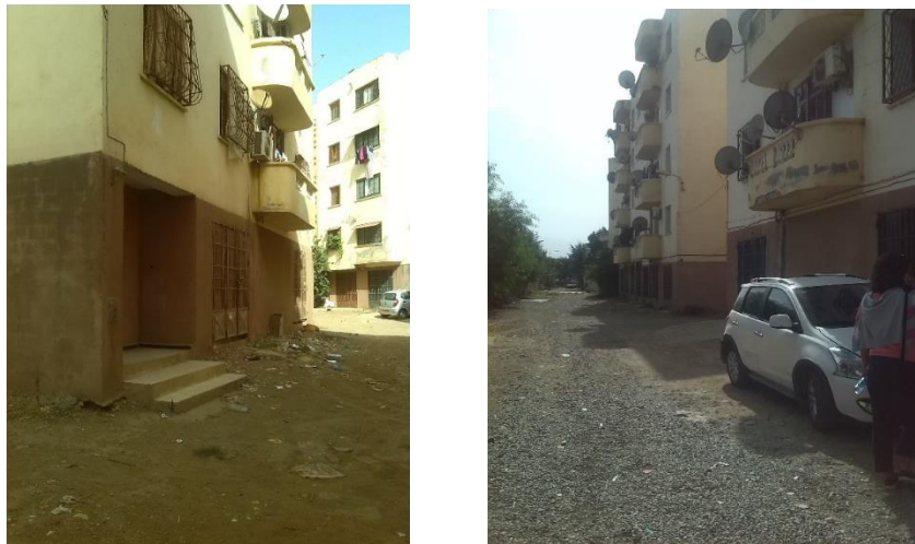
Figure 22: la dégradation des espaces communs de la cité El Karam. Source: photos prises par l'auteure, le 19 mars 2016
