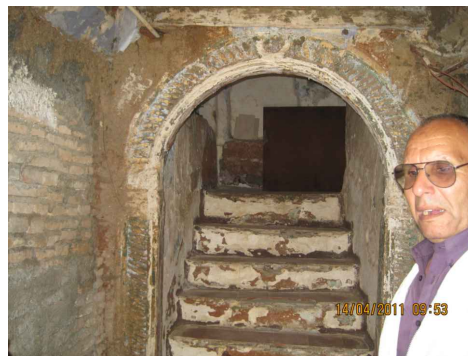
N° 31 rue Benghanif: les carreaux des marches.
