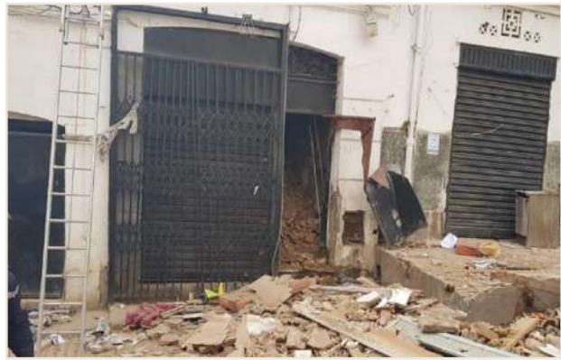
FIGURE 17: EFFONDREMENT D'UN IMMEUBLE, CASBAH D'ALGER. (SOURCE : CAPALGERIE.DZ, 2019).
