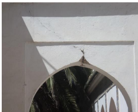
Figure 61 fissuration au niveau des arcades Source auteur
