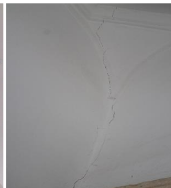
Figure 63 Fissuration au niveau de la coupole Source : auteur
