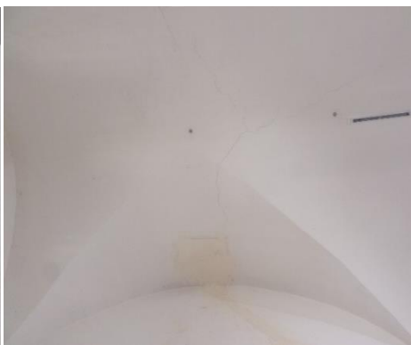
Figure 62 fissuration au niveau des voutes Source : auteur
