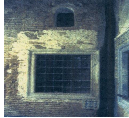
Figure 9 Efflorescence sur un mur Source : ACHAB Samia
