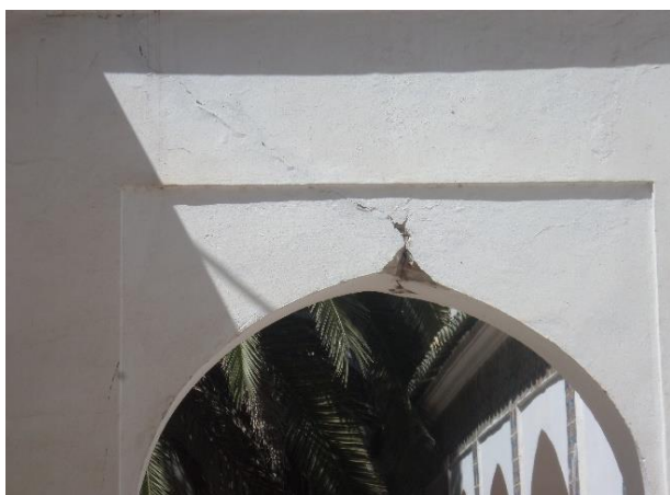
Figure 68 fissuration au niveau des arcades Source : auteur
