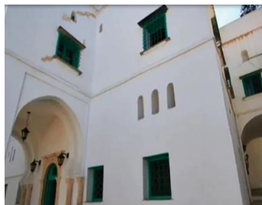
Figure 64 fissuration au niveau des façades (façade ouest) Source auteur
