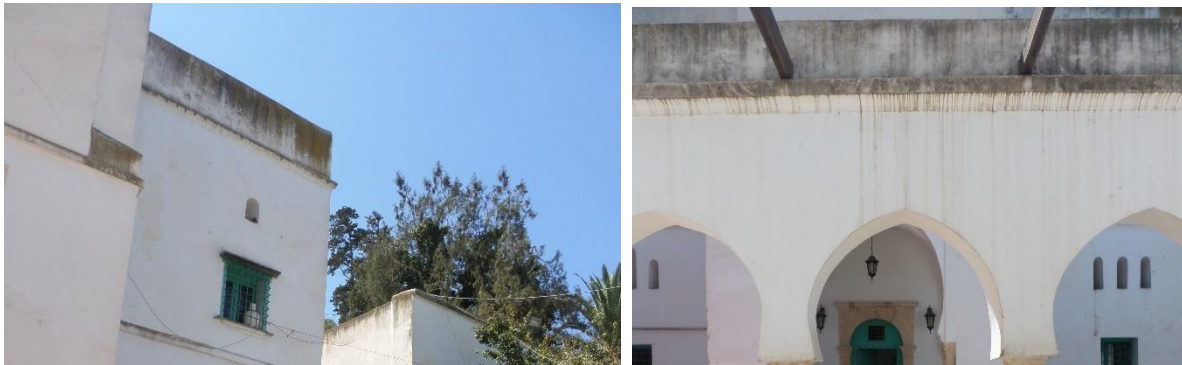
Figure 65 apparition des salpêtres sur élévation Source : auteur
