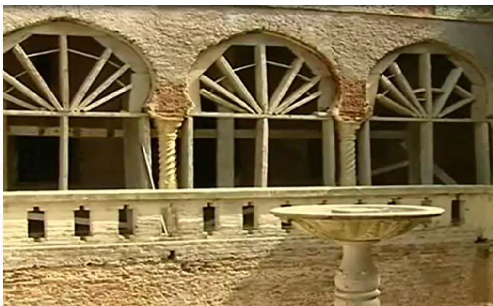
Figure 59 Restauration des arcades de la villa (vue nord-ouest sur la façade du El Riyad Source : Mounjia ABDEL TIF
