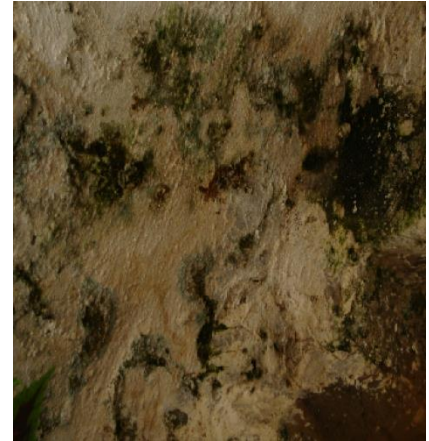
Figure 14 Prolifération de salissures vertes due à une humidité permanente Source : ACHAB Samia
