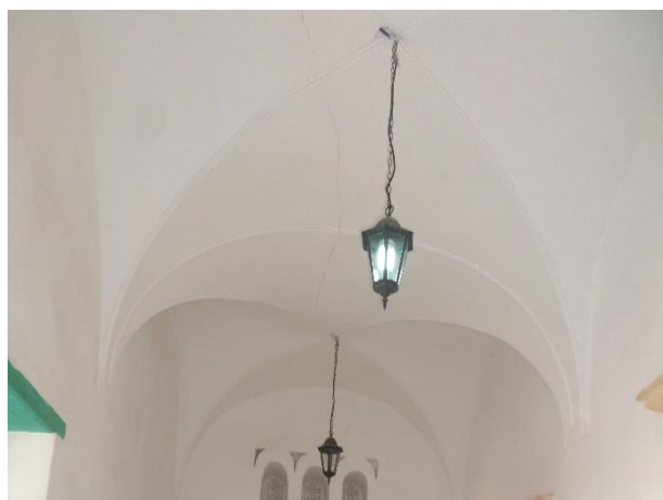
Figure 67 : fissuration au niveau de l'intrados de la voûte Source : Auteur
