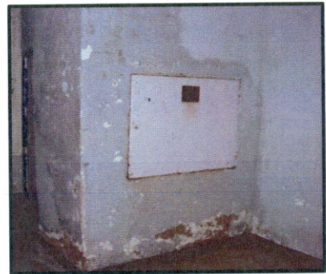
Fig. 27 : photos prises à l'intérieur d'un pavillon dégradé
