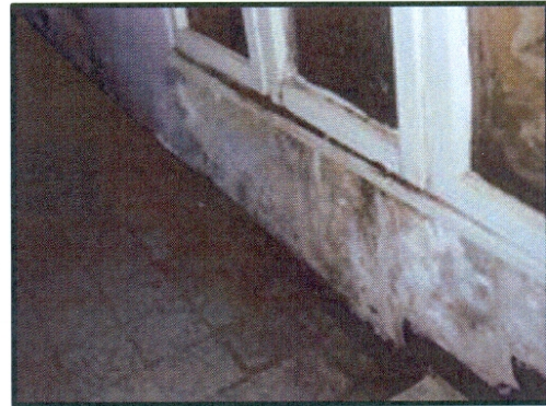
Fig.17 : problèmes d'humidité dans les pavillons
