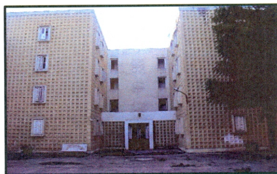
Fig. 14 : pavillon U dégradé
