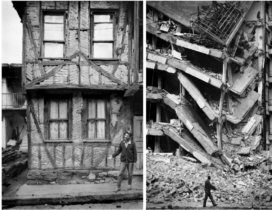
Fig. 11 : Exemple de bonne tenue des constructions traditionnelles en comparaison avec les constructions récentes en béton armé lors du séisme destructeur en Turquie de 1999 [Langenbach R., 2008B].
