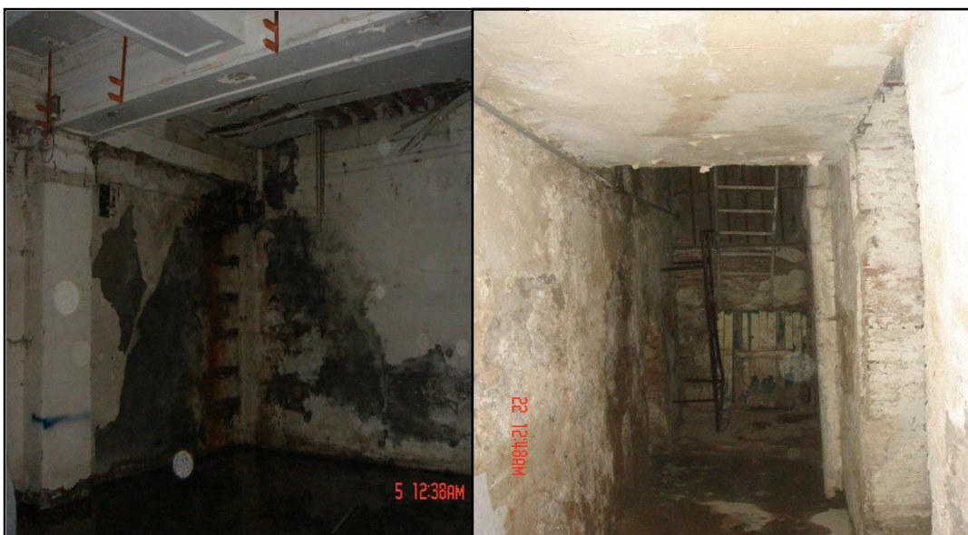
Fig. 22 : Présence d'humidité dans les caves à causes des infiltrations et des inondations [CENEAP & CTC, 2007].
