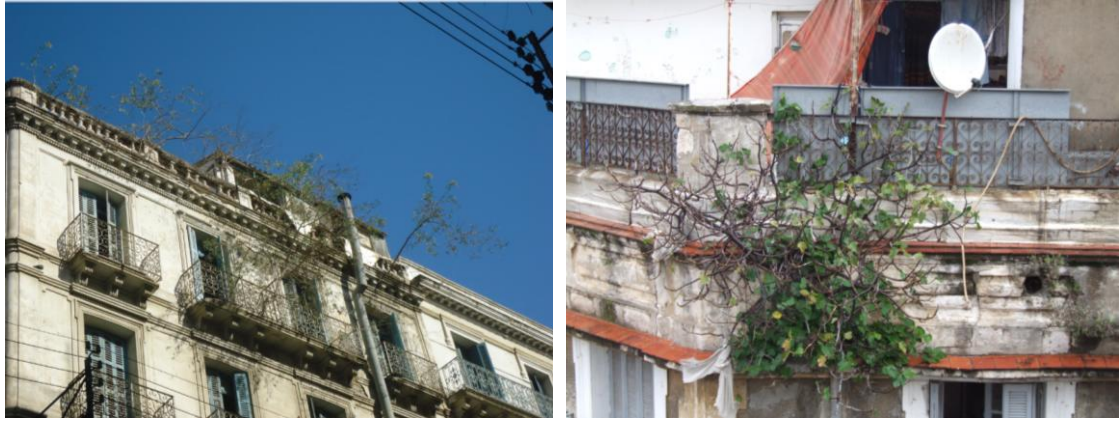
Fig. 25 : Détérioration et manque d'entretien du patrimoine 1830-1930. Prolifération d'une végétation sauvage (Crédit photo : Souami M.A.).
