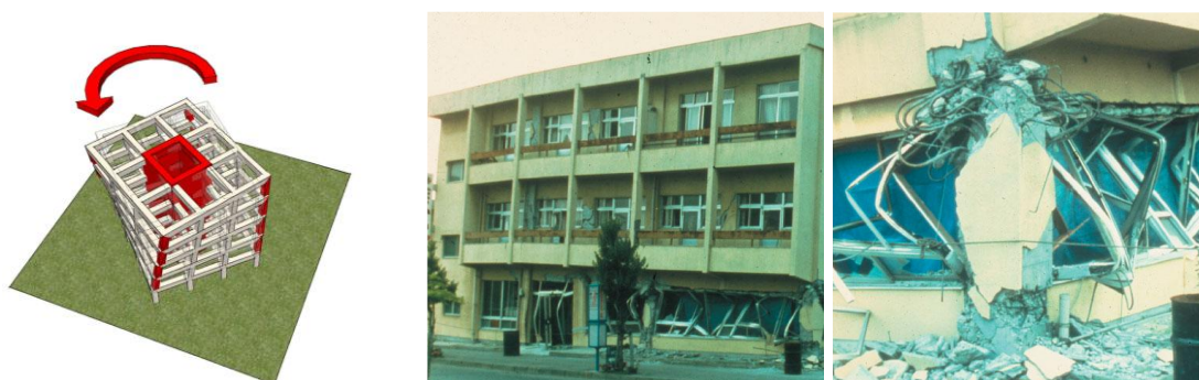
Fig. 36 : Une disposition non symétrique des éléments de contreventement, peut accentuer les effets de torsion. Exemple : séisme de Tokachi-Oki, Japon 1968. (Crédit photo : Djennane W., [Zacek M., 2004]).
