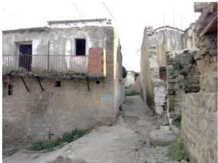
Figure 5 : Dégradation du cadre bâti de la casbah de Dellys. Source : Auteure, 2017
