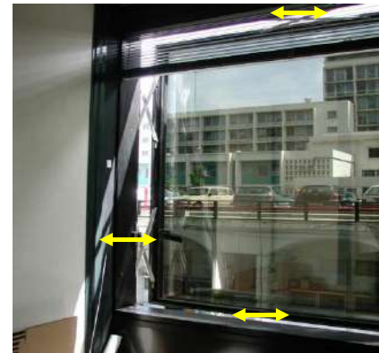
Figure 41 : Type d'ouverture de la fenêtre de désenfumage au siège de la SH (Chabane, 2006, p. 78)
