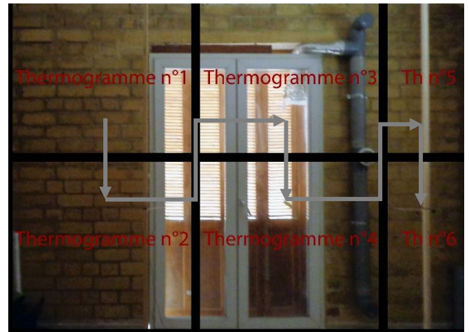
Figure 36 : Suite de prise des images thermiques de la façade orientée est du séjour. Source : Auteur.
