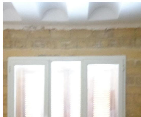
Photographie 5 : Photo de la paroi sud du séjour au niveau de la fenêtre. Source : Auteur.
