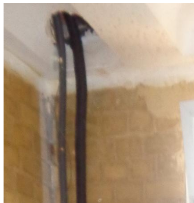
Photographie 10 : photo de la paroi de la d'eau au niveau de la jonction avec le mur de la chambre 2 et le plancher haut. Source : Auteur.
