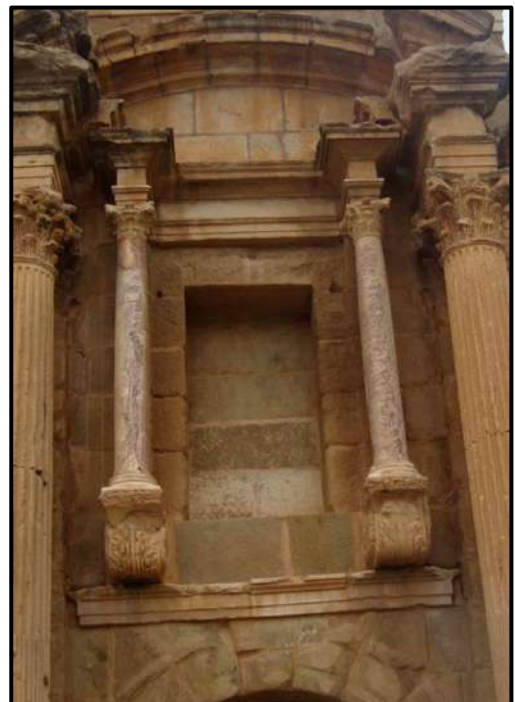
Figure 54: ordre mineur, des niches de l'arc de Timgad. Source: photo prise par l'auteur en Mai 2013.
