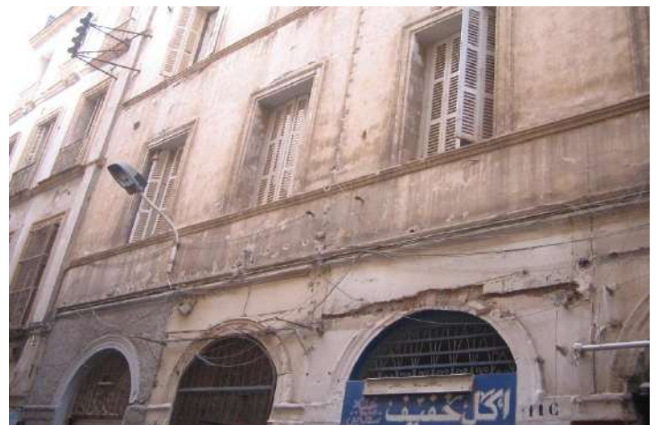
Fig.37 : Relevé d'état de lieux (photo avant décision d'agir, source : photo prise par le BET lors d'une visite au bâtiment
