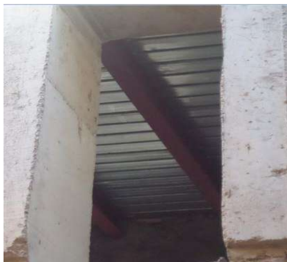
Fig.35 1: Une partie du plancher du troisième étage, source : photo prise sur chantier par l'auteur
