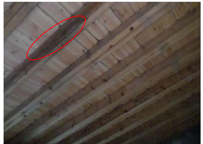
Fig.43 : Avec l'absence d'entretien les solives en bois du plancher sont détériorées, source : photo prise sur chantier par l'auteur
