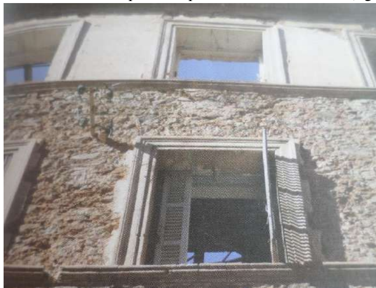
Fig.17 : Les façades décapées et laissées à nu risquant l'humidité et effondrement à cause des infiltrations, source : photographie prise en phase état des lieux réalisé par le BET.
