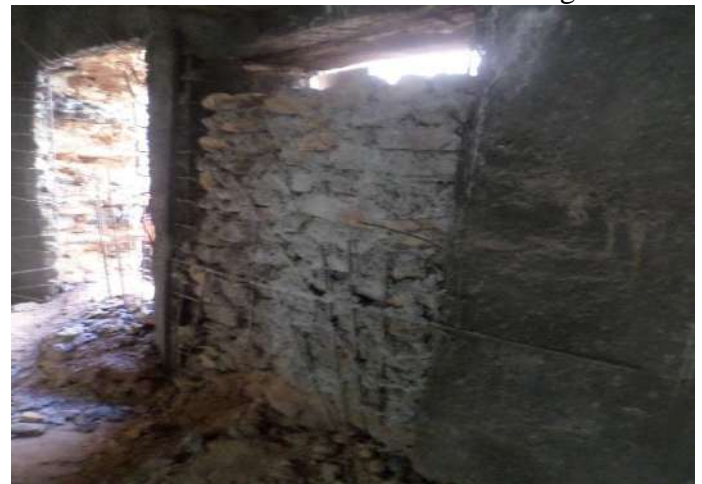
Fig.41 : Résultat d'une étude de faisabilité non complétée (déplacement des anciennes ouvertures pour correspondre au plan), source : photo prise sur chantier par l'auteur
