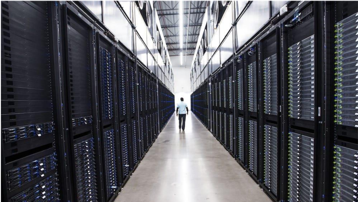
Figure 9 : L'intérieur de datacenter Mesa d'Apple aux Etats Unis (Source : Furno (2018))
