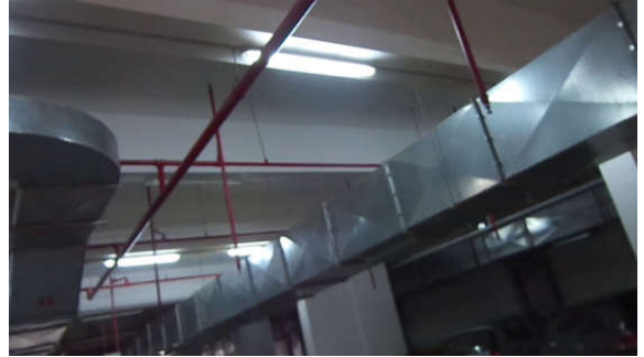
Figure 42: colonnes horizontales d'extraction d'air Source : auteur, 2015
