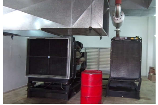
Figure 45: groupe électrogène Source : auteur, 2015
