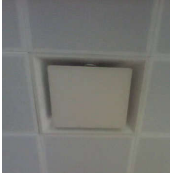
Figure 43: dispositif de chauffage/climatisation (système d'eau glacé VRV) Source : auteur, 2015
