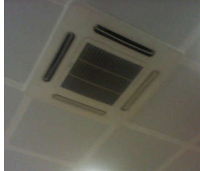
Figure 44: dispositif de chauffage/climatisation toshiba Source : auteur, 2015
