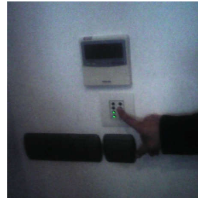
Figure 40: boîte de commande Source : auteur, 2015
