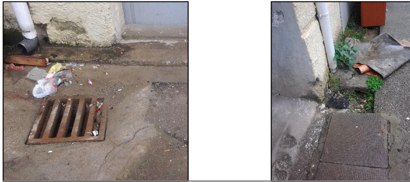
Figure 4.51 : l'absence de l'entretien des regards d'évacuation des eaux
