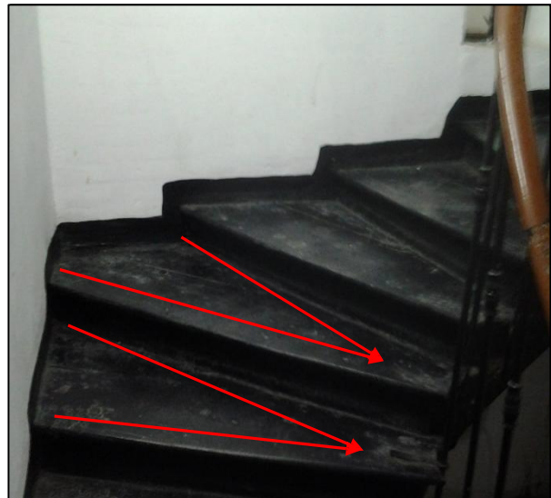
Figure 4.57 : Inclinaison des marches, due au mal encastrement dans les murs porteurs
