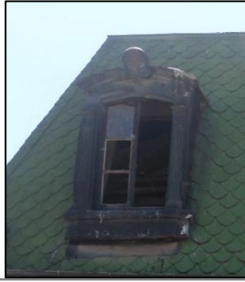
Figure 4.62 : état dégradé des fenêtres
