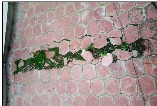
Figure 4.52 : Cassements de revêtement mis en place au niveau de la toiture terrasse
