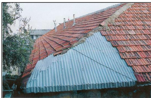
Figure 3.51 : Couverture en tuiles plates dégradée (Tuiles manquantes, prolifération mousses, algues et lichens)
