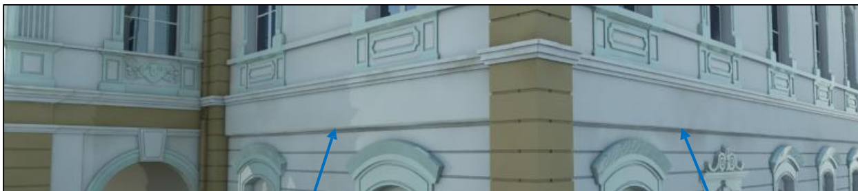
Figure 4.37 : photo en 3D pour illustrer le Rajout de bandes horizontales sortantes (après l'intervention)
