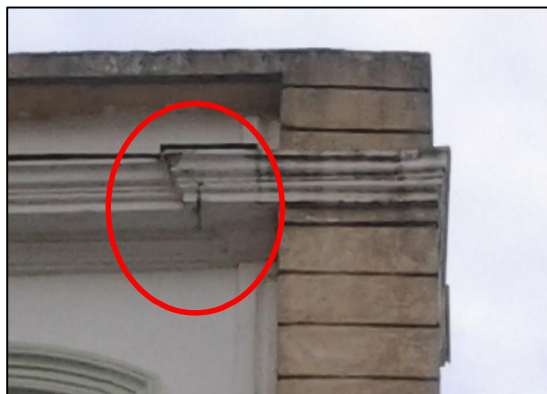
Figure 4.58 : Fissures au niveau des chapiteaux
