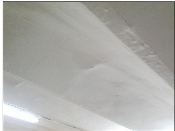
Figure 4.54 : Problème de filtration des eaux à travers le plancher au niveau de sous-sol.
