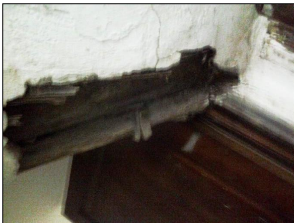
Figure 4.53 : Dommages au niveau du plancher. Ainsi existence de graves fissures
