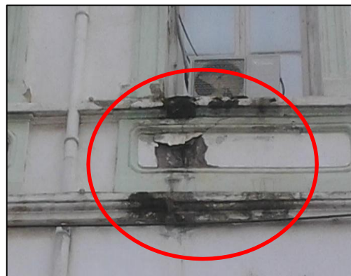
Figure 4.59 : dommages dues à l'écoulement des eaux des climatiseurs
