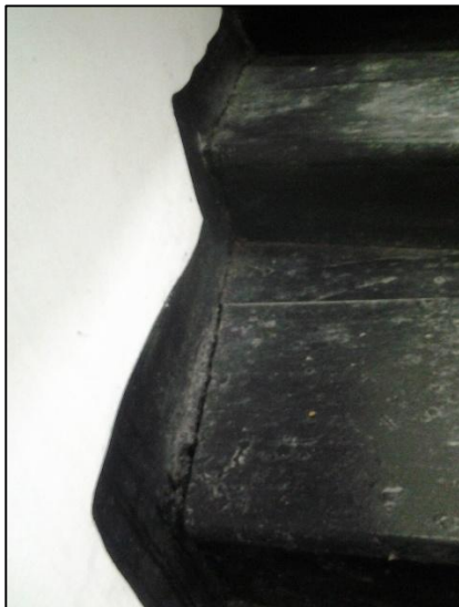
Figure 4.56 : Fissures graves au niveau de l'encastrement des marches dans les murs porteurs
