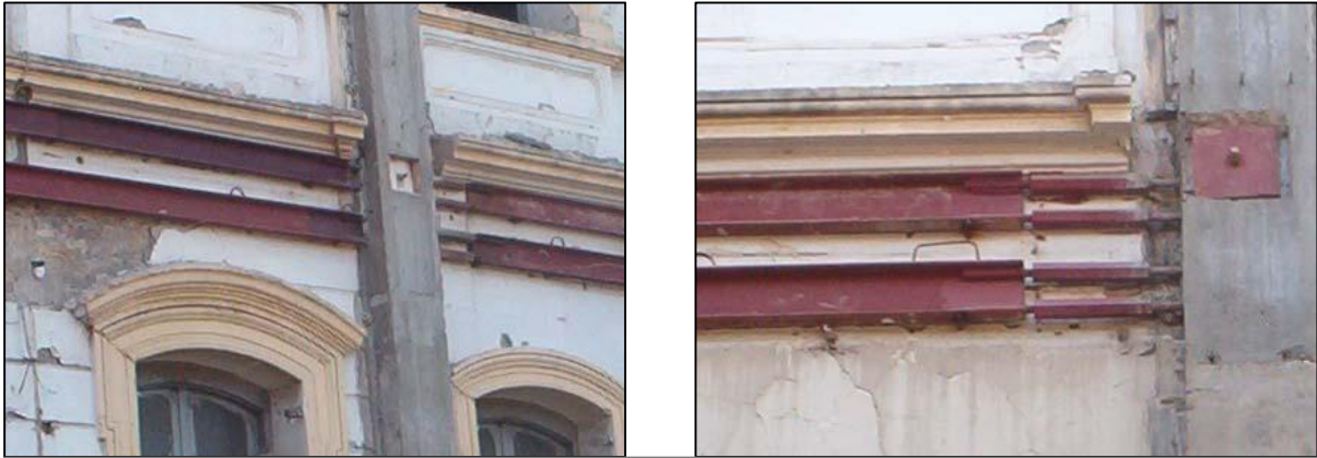
Figure 4.71 : Détail sur la connexion entre les deux chainages IPN 200 et béton armé
