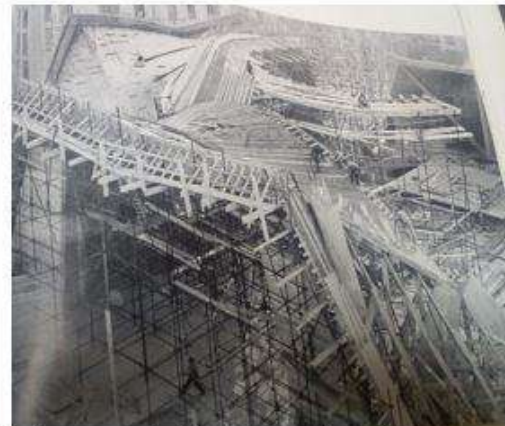
Fig 80 : Construction de la tour avec un coffrage grim pant « Faye », en chantier 1960 (Source : Revue « La construction moderne », 78e année, N°1, 1962, Pp. 229)
