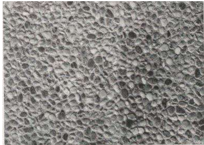
Fig 49 : Revêtement extérieur du Palais du Gouvernement Général d'Algérie (Source : Revue Chantiers, Décembre 1933, J. COTEREAU« Le building du Gouvernement Général à Alger », Pp. 1214)
