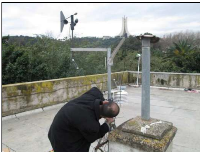
Figure 94 : Installation de la station météo HOBO du jardin zoologique en hiver
