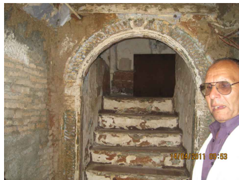
N° 31 rue Benghanif: les carreaux des marches.
