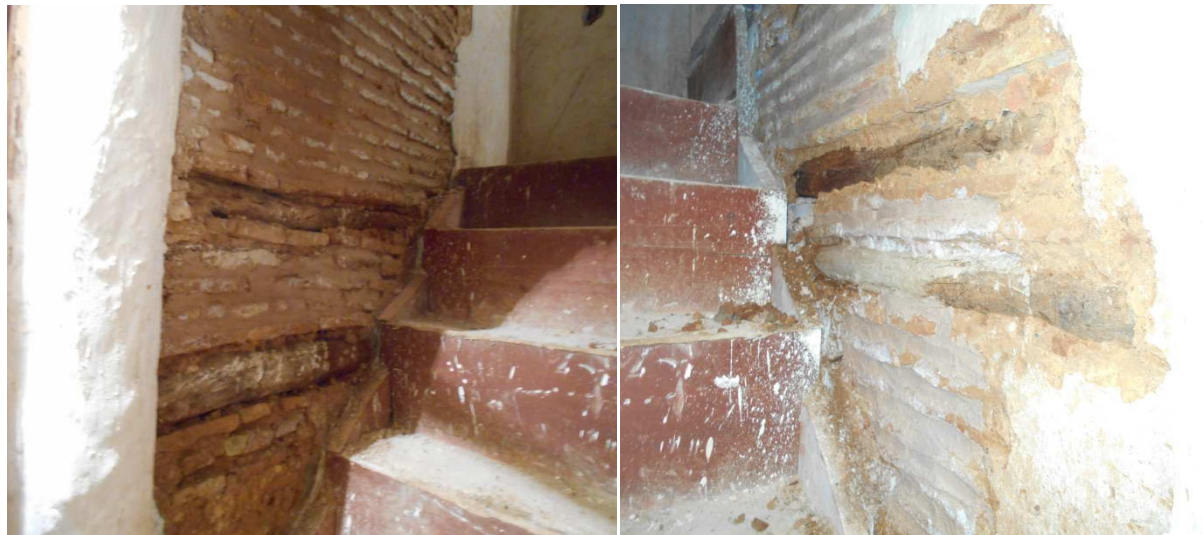
Photo 11 : Les rondins de chainage de la Dwira N°20 rue des frères Lakhdari 231 .
