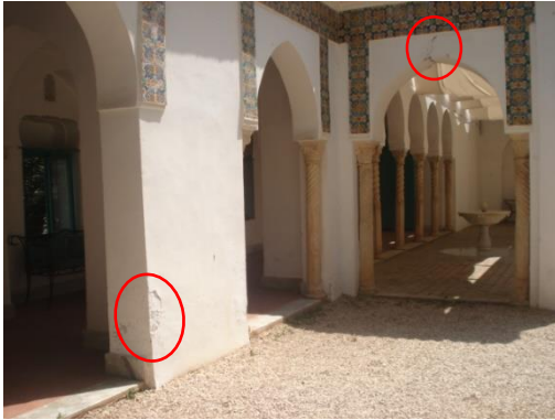
Figure 5.31 : fissurations superficielles dans un mur d'arcade. Source : l'auteur.
