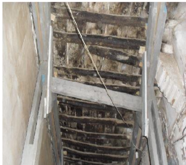
Figure 3.21 : fléchissement du bois d'un plancher du probablement à une sollicitation excessive. Source : ACHAB Samia Ep CHERNAI (juin 2012)
