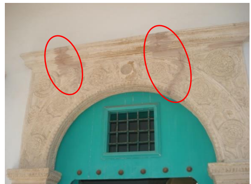
Figure 5.34 : fissurations superficielles dans des arcatures d'ouverture. Source : l'auteur.
