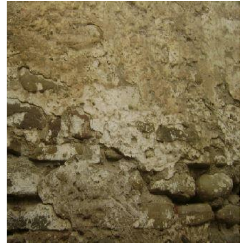
Figure 3.22 : détérioration de l'enduit par vieillissement.
