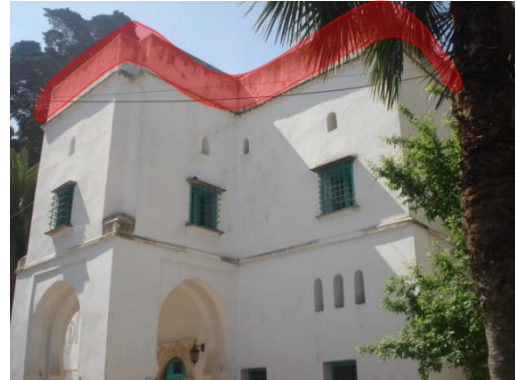
Figure 5.32 : fissurations superficielles dans l'acrotère. Source : l'auteur.
