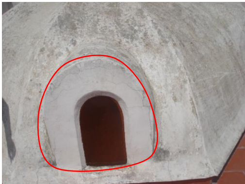
Figure 5.33 : fissurations superficielles dans une coupole couvrant la toiture. Source : l'auteur.
