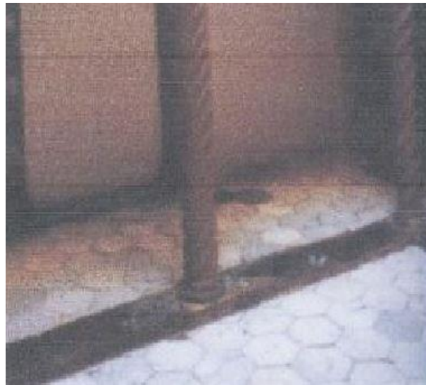
Figure 3.18 : revêtement de la galerie d'une demeure en céramique en forme de tomettes.
