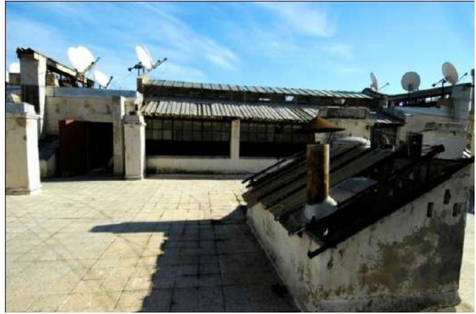
Photo 34 : Verre et tôles sur atrium et courette de service, (Source : Auteur)
