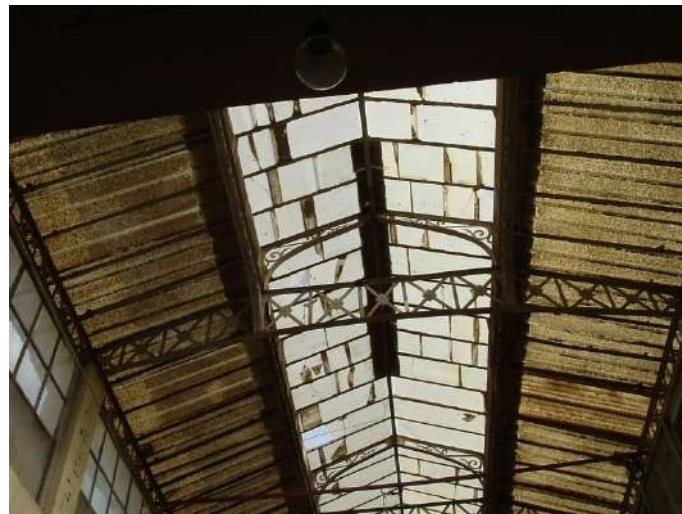
Photo 55 : Transmittance réduite de la couverture « vitrée »
