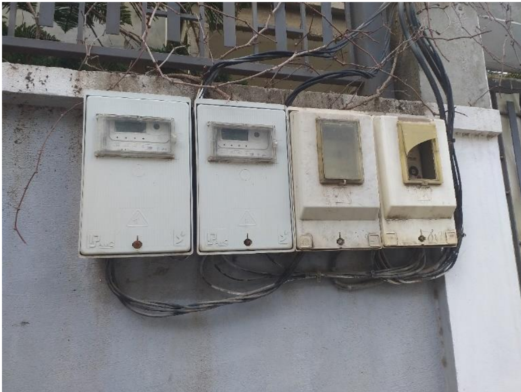
Figure 34 : Les anciens et les nouveaux compteurs installés mitoyens Source : Auteur 2019
