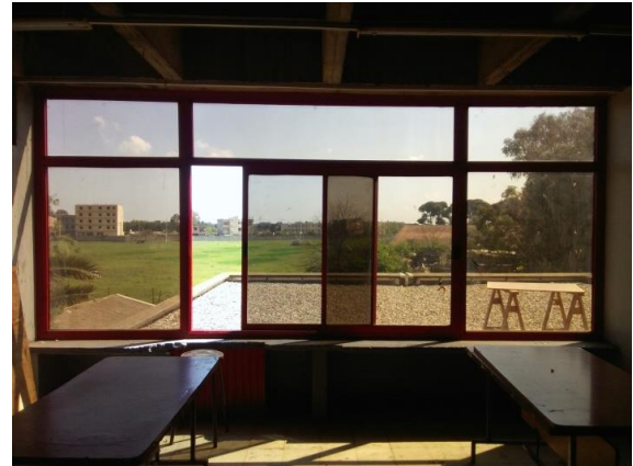
Figure 65: Vitrages réfléchissants utilisés actuellement au niveau des ateliers. Source Auteur
