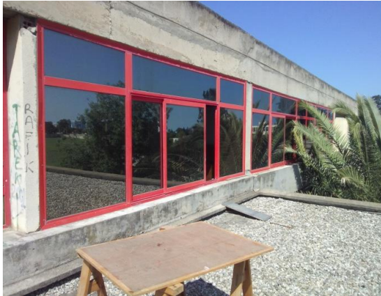
Figure 66: Vitrages réfléchissants utilisés actuellement au niveau des ateliers. Source Auteur
