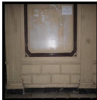
Fig85 : simili-pierre du soubassement (source : auteure 2018)
