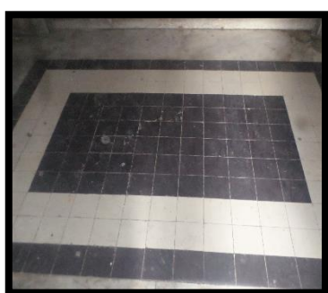
Fig131 : revêtement en grés-cérame (source : auteure 2018)
