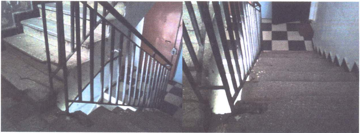
Figure 3 : les escaliers en très mauvais état qui représentent un risque sur la vie des habitants, en plus de l'absence de l'ascenseur (Source : prise personnelle, 2014)
