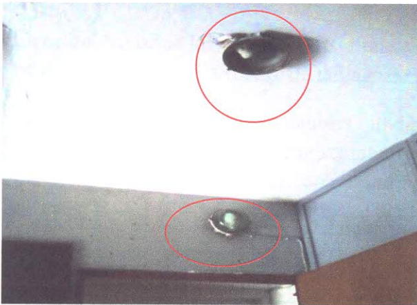
Figure 4 : L'éclairage de la cage d'escalier qui n'est pas naturel (Source : prise personnelle, 2014)
