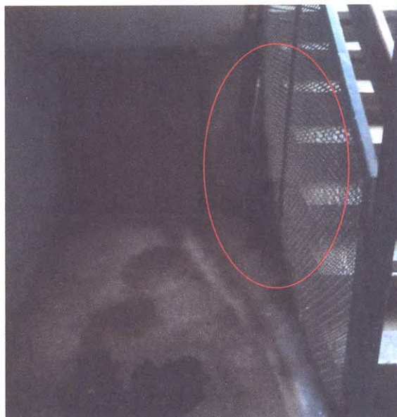
Figure 2 : L'absence d'entretien au niveau des escaliers (Source : prise personnelle, 2014)
