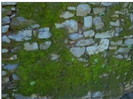
Fig 2.47: Prolifération de la végétation dans les soubassements d'un mur en pierre. Source : S.Allili, p 108
