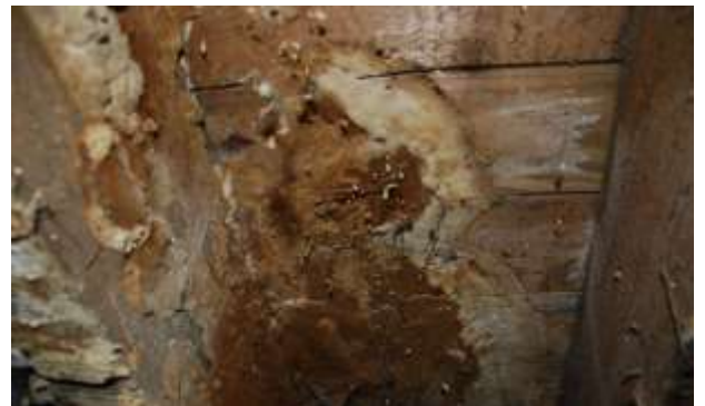
Fig 2.44 : putréfaction d'un plancher en bois Sous l'effet de l'humidité Source : S.Allili ,p120
