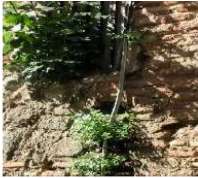
Fig 2.49 : Présence d'un figuier dans un mur. Source : S.Allili, p110
