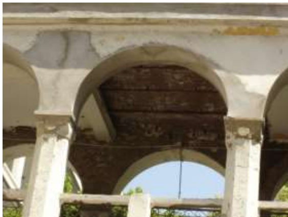
Fig. 4,119 : Fissures au niveau des arcades Source : B.E.T Harchaoui.2010
