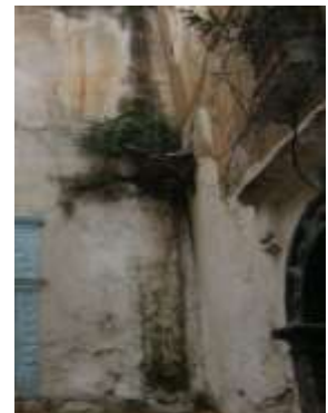
Fig 2.45 : Cloquage de l'enduit sous l'effet de l'humidité. Source : S.Allili ,p120
