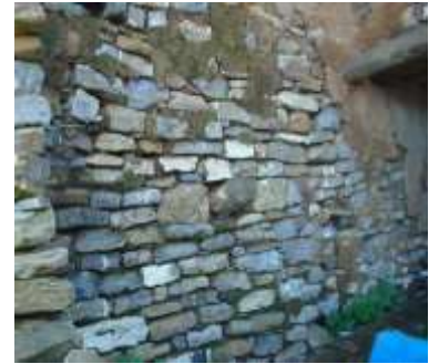
Fig 2.43 : dégradation du mortier d'un mur en pierre. Source : S.Allili, p99
