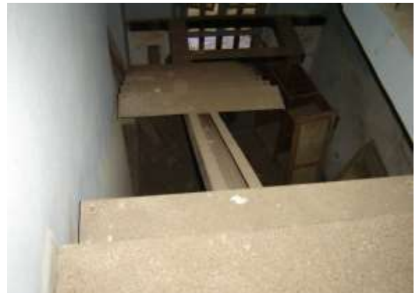
Fig. 4,120 : Escalier dépourvu de marche et de palier de Repos Source : B.E.T Harchaoui.2010
