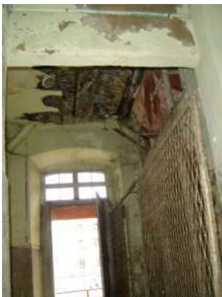
Fig. 4,123 : Corrosion avancée des Solives métallique du plancher en voutain des sanitaires. Source : B.E.T Harchaoui.2010
