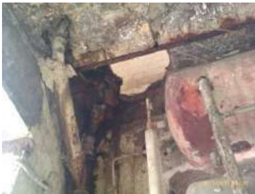
Fig. 4,131 : Etat de dégradation avancé des plancher du bloc 4 Source : B.E.T Harchaoui.2010
