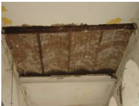
Fig 39 : corrosion des poutrelles métalliques D'un plancher en voutain.
