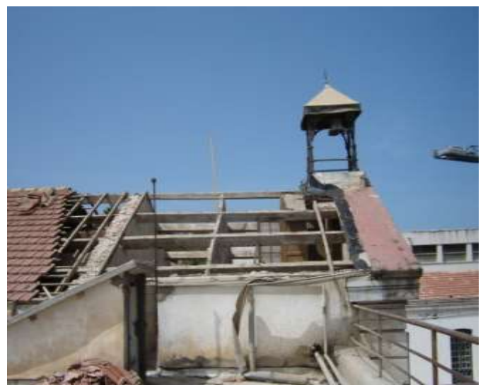
Fig. 4,124 : rupture de fermes en bois et soulèvement des tuiles.
