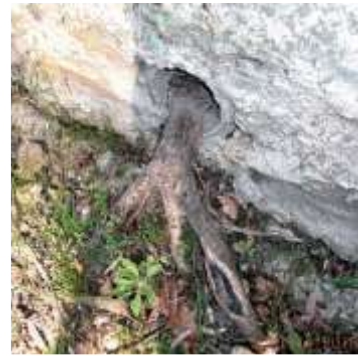
Fig 2.50: Racine dans un mur de soutènement. Source : : S.Allili,, p 109
