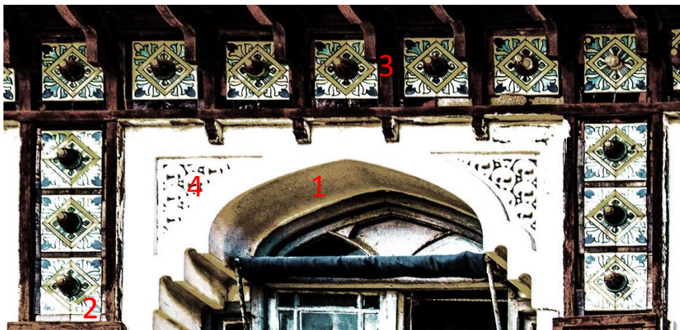
Figure 58 : détail de l'auvent supporter avec des consoles en bois avec les carreaux de céramique Source : Auteur
