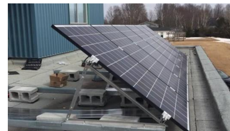
Figure 36 : Panneaux solaires photovoltaïques sur l'école primaire Eliot River, Ile-du-Prince-Edouard
