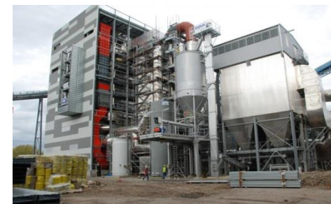
Figure 40 : Centrale de Cogénération Biomasse de Metz-Chambière Source : 224
