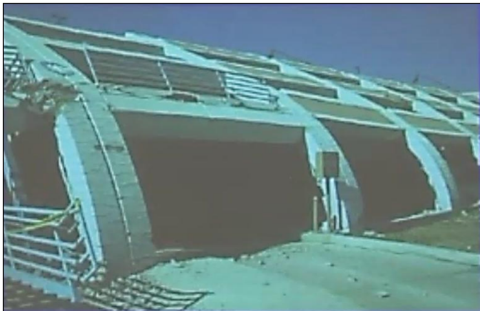
Photo.5. Résultat de l'effet de la ductilité sur un bâtiment ébranlé par un séisme.
