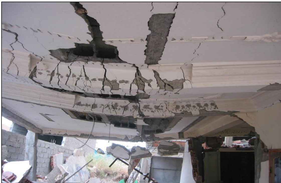
Photo.13. Séisme Alger du 21/05/03, rupture de poutre en flexion
