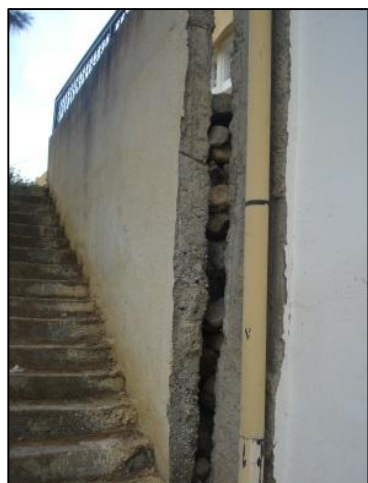
Photo.49. déplacement d'un mur de soutènement de la cour et apparition du remblai de remplissage.
