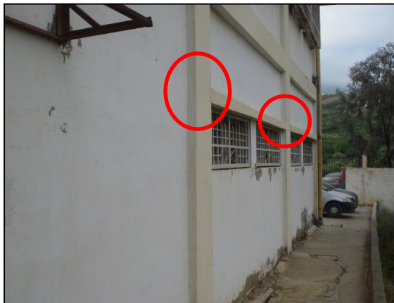
Photo.51. Effet poteau court au sous-sol (cuisine de l'école), bloc D Source : auteur, 2015/2016.
