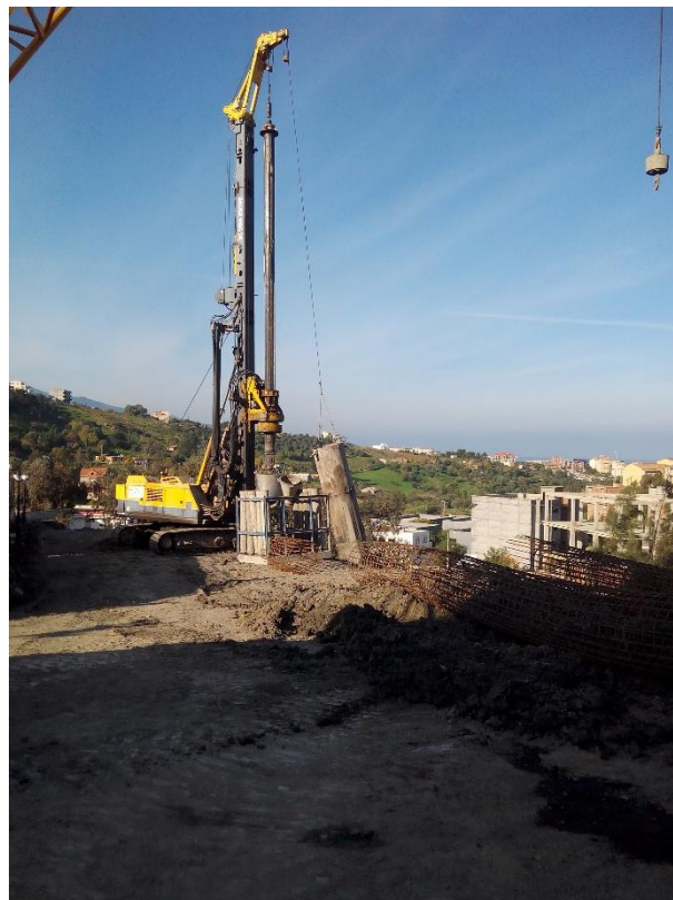
Annexe 2. Photo de la mise en œuvre des pieux en béton armé coulés sur in situ
