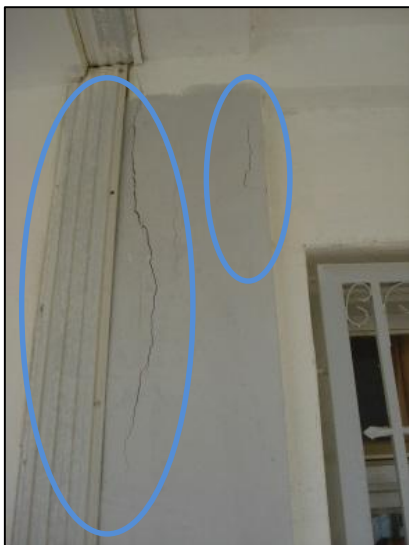
Photo.47. Fissure verticale du poteau. Source : auteur, 2015/2016.
