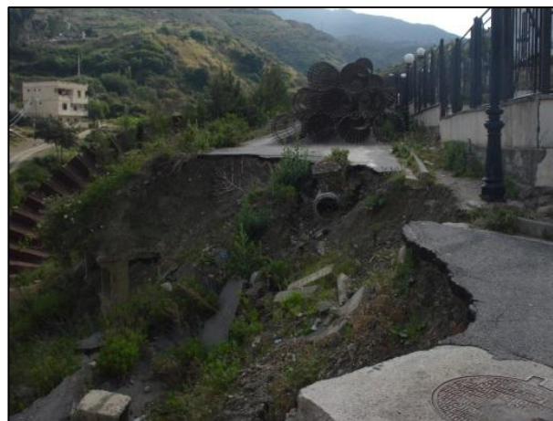
Photo.44. désordres provoqués par le glissement malgré le soutènement avec des palplanches, effondrement de la route qui dessert le CEM.
