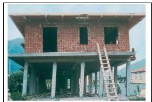
Photo.4. Photo d'un bâtiment à RDC flexible endommagé par un séisme.
