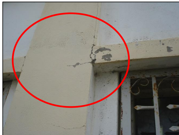
Photo.52. Risque de cisaillement du poteau dû à l'effet poteau court. Source : auteur, 2015/2016.
