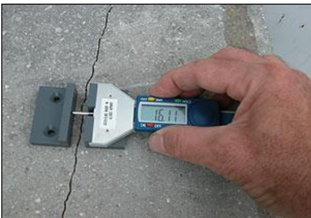
Photo.8. Mesure d'une fissure à l'aide d'un fissuromètre.
