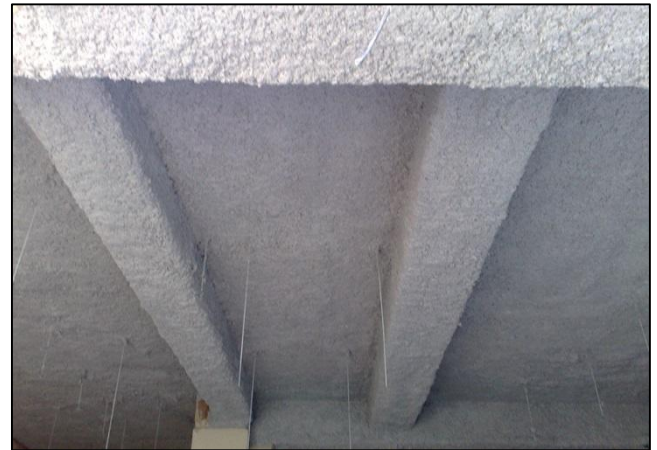
photo.33. Aspect, d'un plancher et de poutres renforcés par chemisage en béton, grâce à la technique de projection de béton.
