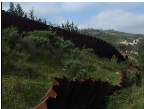
Photo.43. soutènement en palplanches du talus nord succombant à la force de buté du glissement
