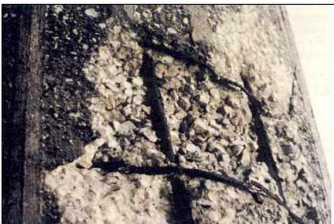
Photo.30. Dégradation du béton due à l'insuffisance d'épaisseur d'enrobage.
