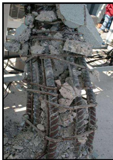
Photo.20. Chili 2010/ Armatures transversales trop espacées et insuffisamment ancrées, pourcentage élevé des armatures longitudinales de diamètre important eu égard aux dimensions du poteau Source : Groupe de travail AFPCSTB, Diagnostic et renforcement du bâti existant vis-à-vis du séisme, CSTB, Mars 2013, p62
