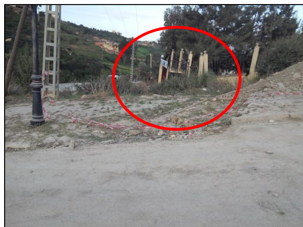
Photo. 54. Aperçu des dommages subis par le sol autour de la construction, route desservant l'hôpital au sud. Source : auteur, 2015/2016.
