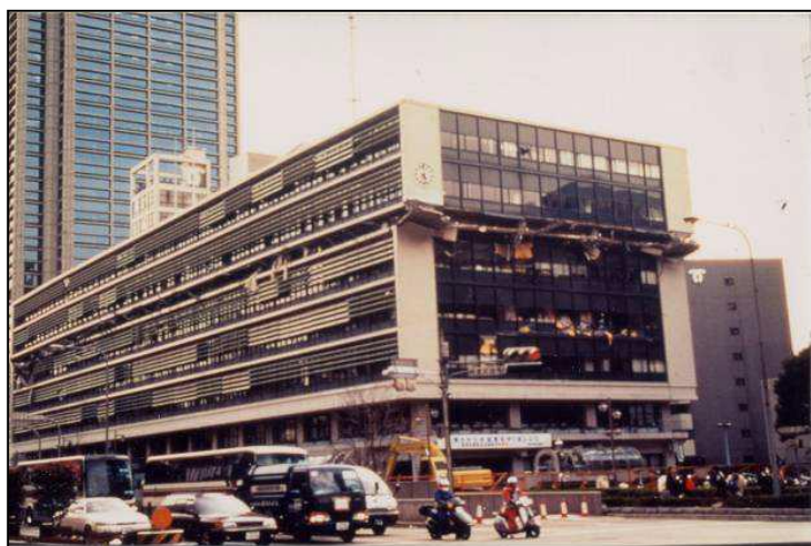
Photo.15. Kobé 1999 – Mairie, rupture du 6ème niveau
