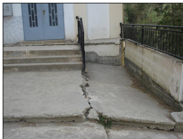
Photo.50. Tassements différentiels remarquables du sol de l'aire de jeu
