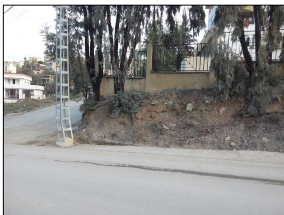
Photo.53. photo de la partie sud du CEM (ouvrage sur remblais) Source : auteur, 2015/2016.
