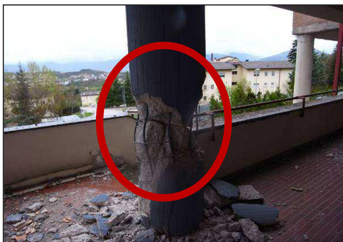
Photo.17. L'Aquila 2009 Pettino, endommagement de poteaux courts par cisaillement et un manque de confinement transversal.
