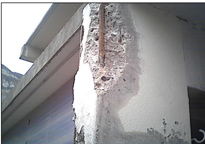
Photo.11. Effet de la carbonatation sur un poteau
