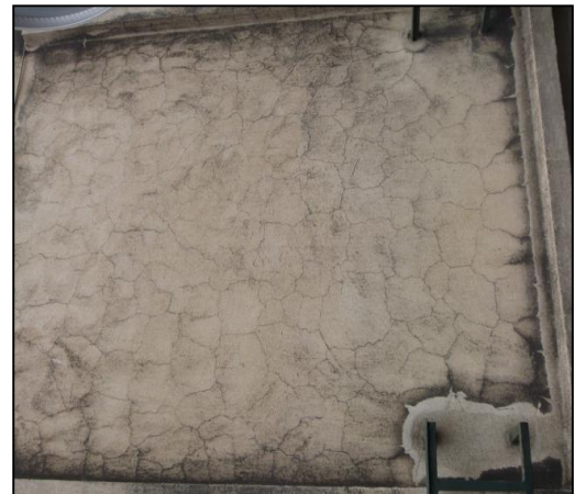
Photo.9. Effet du faïençage sur un mur
