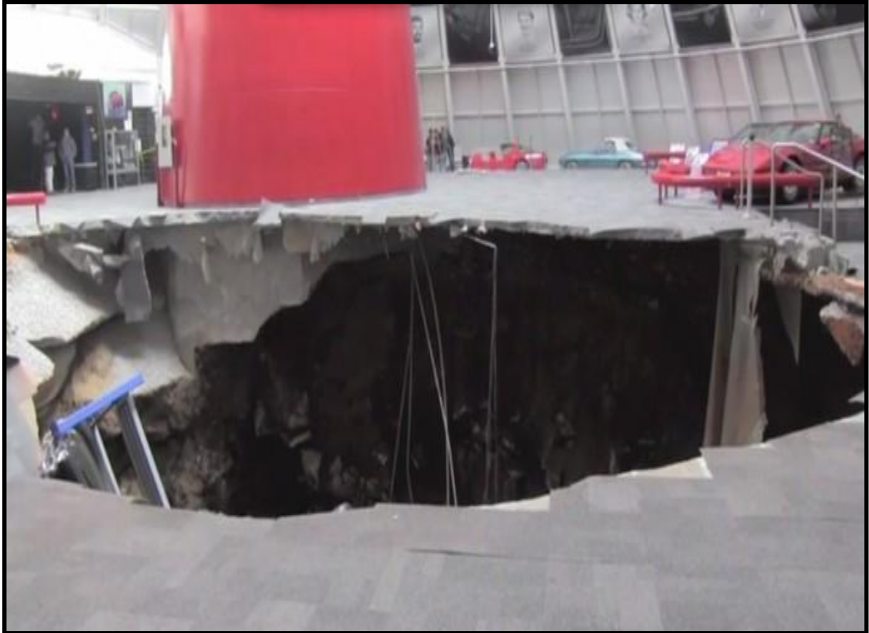
Photo.21. Effondrement du sol du musée national Corvette à Bowling Green dans le Kentucky (Etude de sol malle faite).
