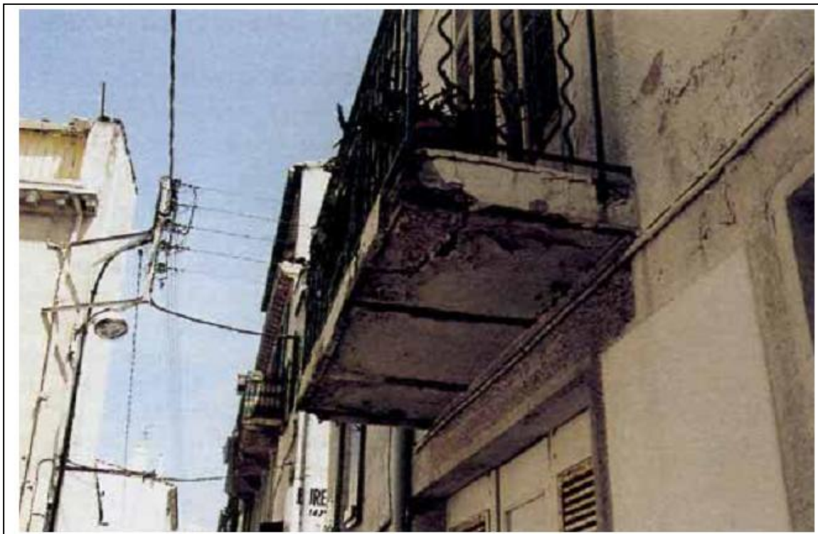
Photo.10. Corrosion de l'armature métallique d'un balcon. Sous l'effet de la corrosion des armatures, le béton armé de recouvrement s'est fissuré et a éclaté. Ces destructions mettent en cause la stabilité de ce balcon face à une surcharge ou un séisme.
