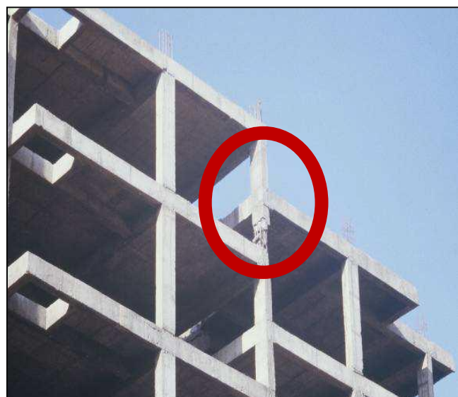
Photo.18. Bhuj 2001 Poteaux courts dus à des niveaux de Plancher décalés.
