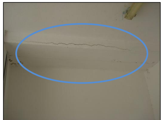
Photo.48. Fissure horizontale de poutre. Source : auteur, 2015/2016.
