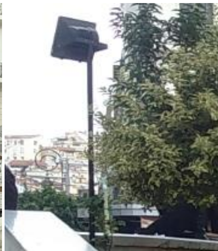
Figure 111: Les luminaires publics placés dans la place Émir.
