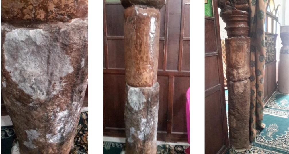
Figure 109 : Dégradation de certaines colonnes
