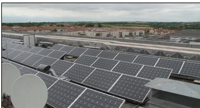
Fig.I.22. Panneaux photovoltaïques en toiture de lycée Kyoto .
