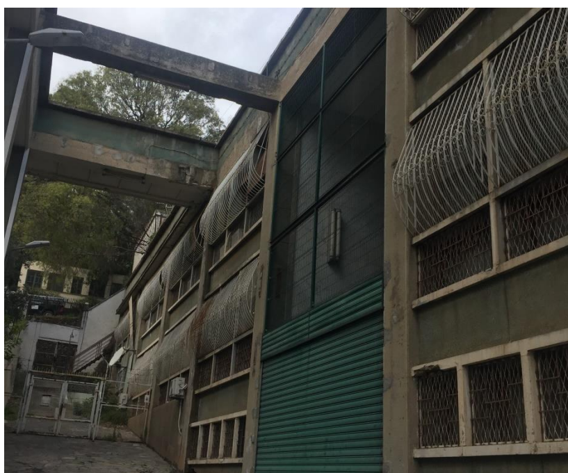
Figure 38 : Rampe latérale de l'édifice, dégradation du mur des poutres extérieures
