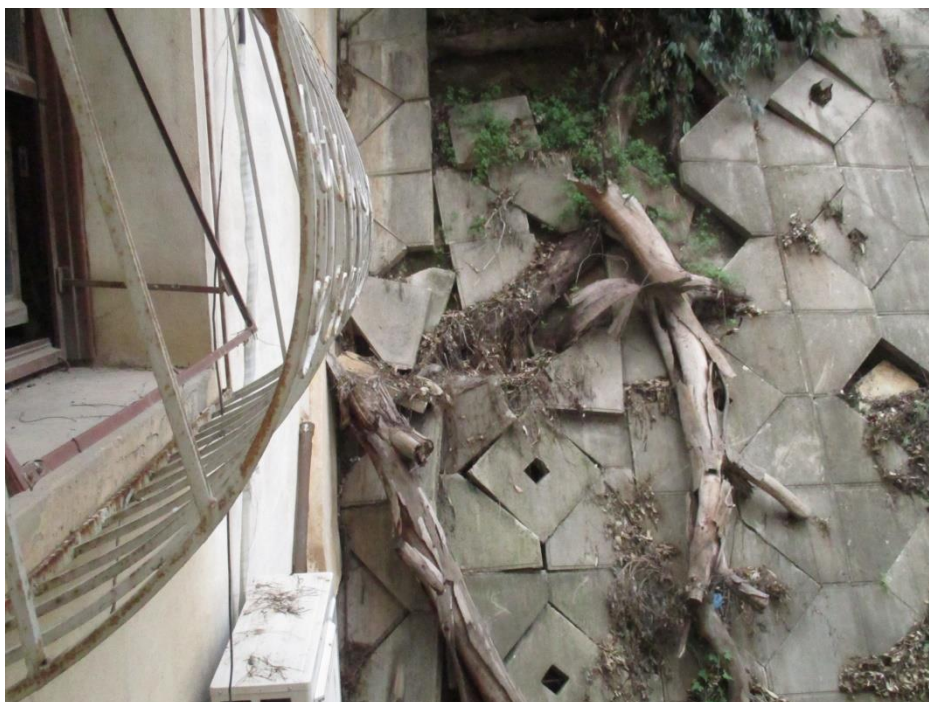
Figure 37 : La cour anglaise arrière, dégradation du mur de soutènement
