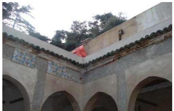
Figure 1 : patio de la villa Abd-el-Tif dénudé de ses carreaux de faïence, photo : auteur.
