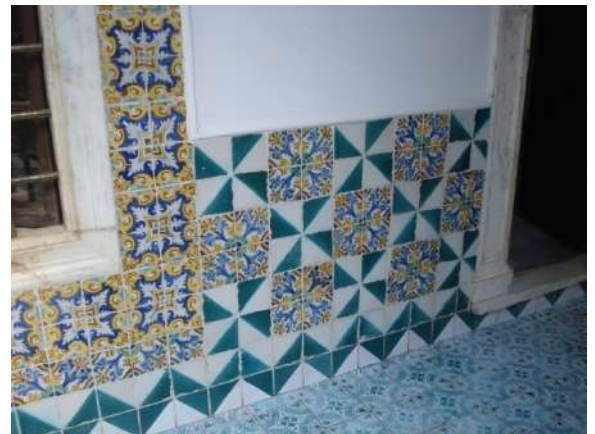
Figure 37 : Le modèle de carreau de faïence de l'encadrement de fenêtre différent de ceux du soubassement. Photo : auteur
