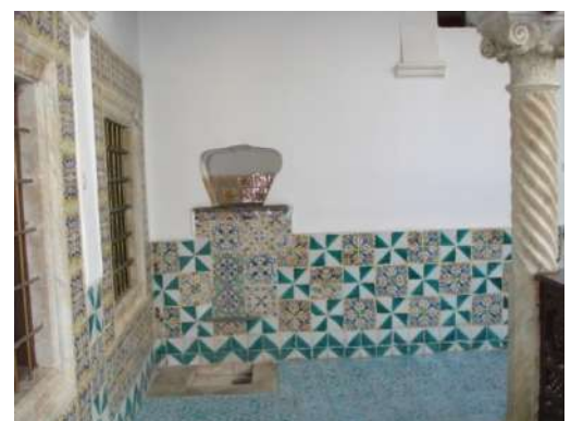
Figure 40 : Trace d'une fontaine sur la paroi sud-est de la galerie supérieure. Photo : auteur.
