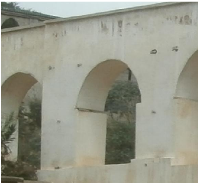
Photo 19: Les trous de boulins fermés avec des rondis non retirée. photo prise par l'auteur aout 2015
