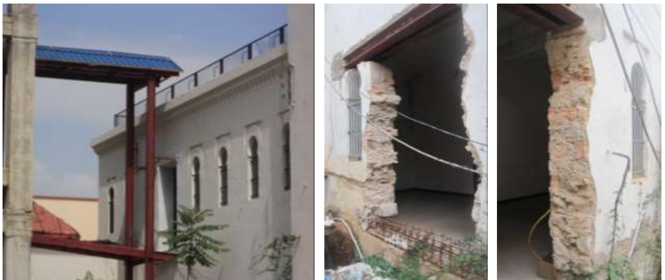
Fig. 162 – Percements exécutés sur la façade latérale gauche, médersa de Tlemcen Source : L'Auteur (2013-2014)
