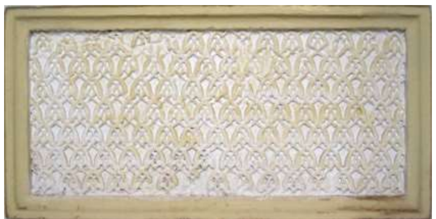
Fig. 168 – Panneau de motifs sebka au niveau des escaliers Source : L'Auteur (2013)
