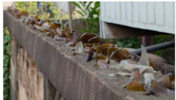
Figure 37: Mur de clôture se terminant par des morceaux de verres cassés
