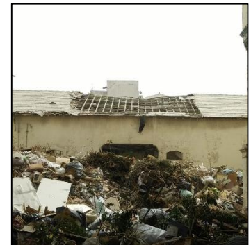
Figure 77 : détérioration de la toiture du bloc 2 Source : Auteur
