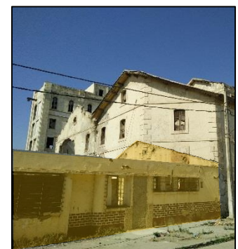
Figure 78 : effondrement de la toiture du bloc 3 Source : Auteur
