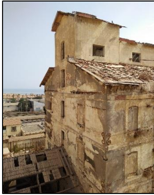
Figure 72 : altération des murs porteurs, vue de l'extérieur Source : Auteur
