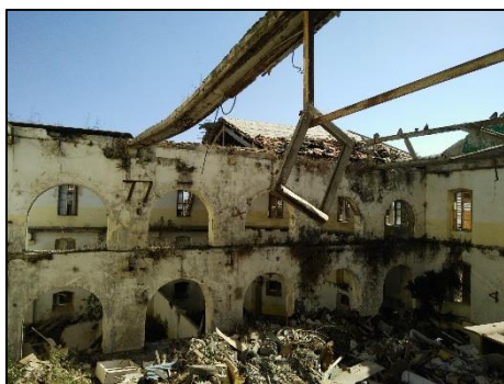
Figure 80 : ravages interne du bloc 4
