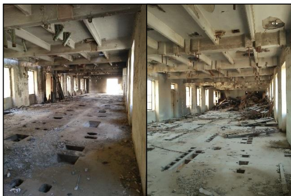
Figure 95 : état des planchers aux étages supérieurs du bloc 1 Source : Auteur
