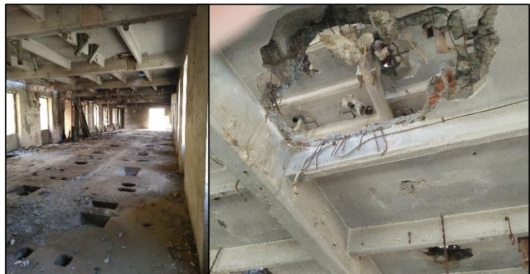
Figure 67 : état des planchers Source : Auteur
