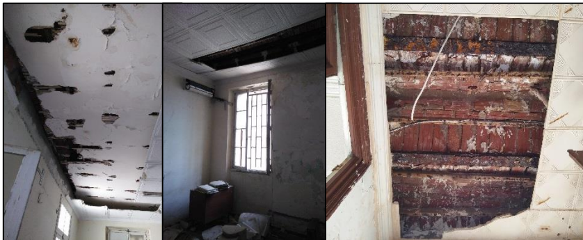
Figure 70 : état de dégradation du bloc 8 à l'intérieure Source : Auteur
