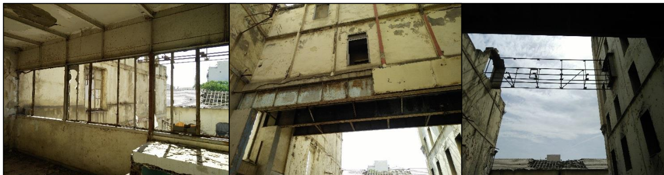
Figure 79 : vues intérieurs et extérieurs des deux passerelles qui relient le bloc 1 au bloc 4
