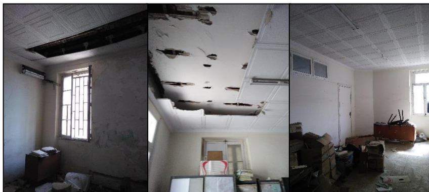
Figure 133 : état de quelques salles du bloc des impôts Source : Auteur
