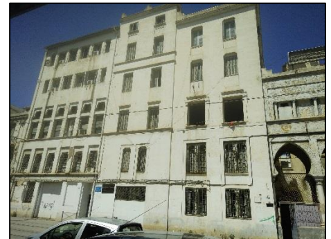
Figure 71 : état façade principale du bloc 8 Source : Auteur
