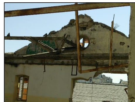
Figure 82 : dégât de la toiture du bloc 4
