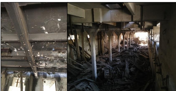
Figure 68 : altérations causés par l'incendie Source : Auteur
