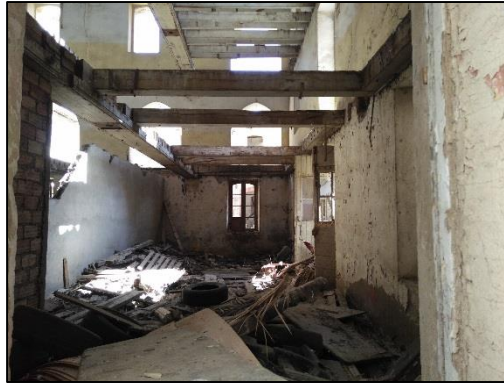
Figure 73 : dégradations des planchers Source : Auteur
