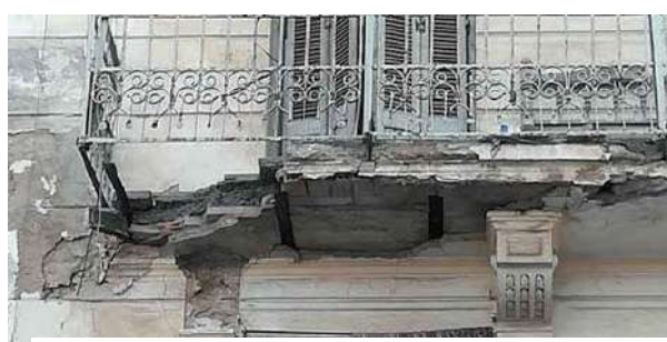
Figure 2.2. Effondrement d'une partie d'un balcon à l'Hussein Dey, le 19/07/2018. Source : http://www.tribunelecteurs.com/
