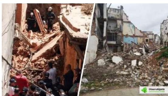
Figure 1.1. Effondrement d'un immeuble colonial à la Casbah le 05/12/2020. Source: www.observalgerie.com
