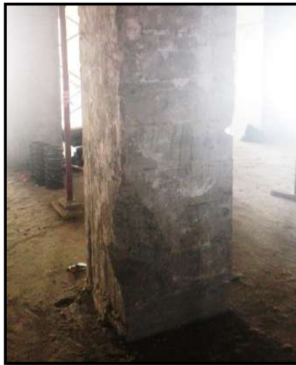
Figure 22 : Exemple d'un poteau sans ferrailage Source : Auteur
