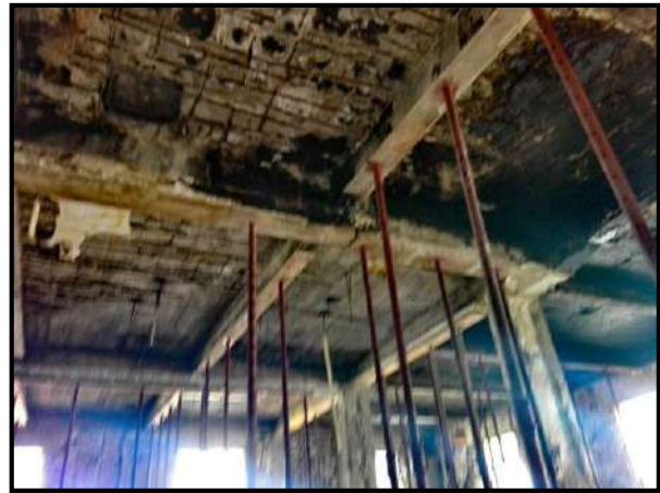
Figure 11 : Corrosion due à l'étanchéité sous-carrelage Source : Auteur
