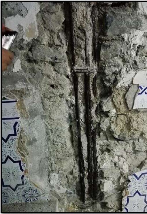
Figure 10 : Etat avancé de corrosion, Cas d'un poteau au niveau du sous-sol Source : Auteur
