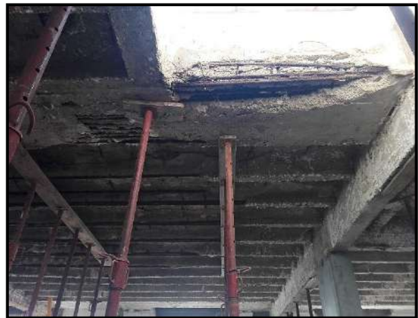
Figure 12 : Corrosion des armatures d'une poutre, sous gaine technique Source : Auteur
