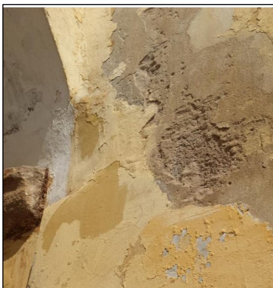
Figure 79 : un état dégradé du mur du fort /source : Auteur.
