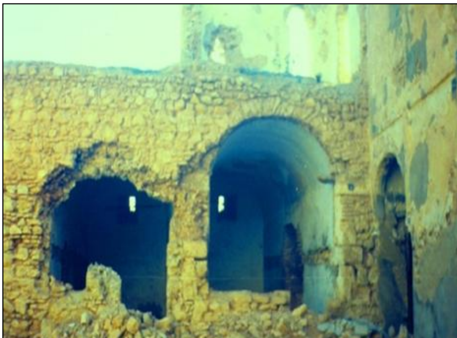
Figure 50 : photo représente une vue sur les pièces, côté ouest détruites ( f00 19, FO 029) Source : Photo prise par le bureau d'étude ARTEC
