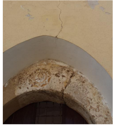
Figure 72 : fissure au niveau de mur de la cour du Fort source : Auteur
