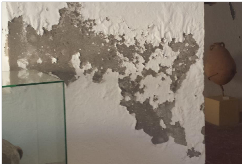
Figure 70 : décollement de l'enduit du mur intérieur Source : photo prise par l'auteur du mémoire
