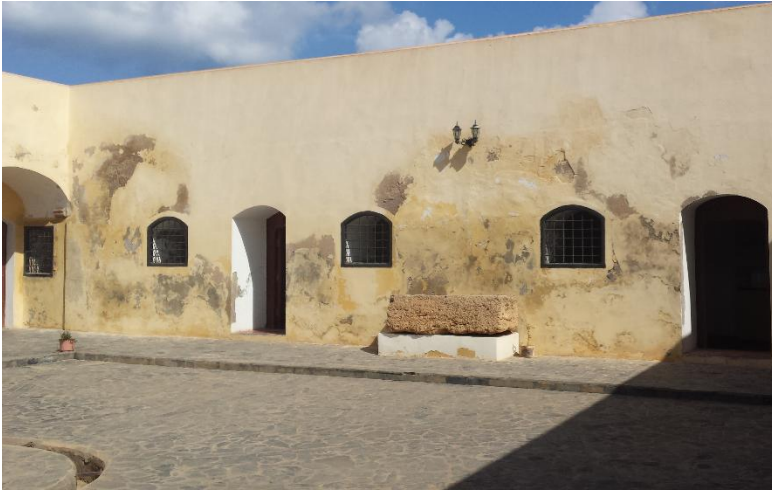
Figure 71 : Éclatement et décollement de l'enduit du mur / source : Auteur
