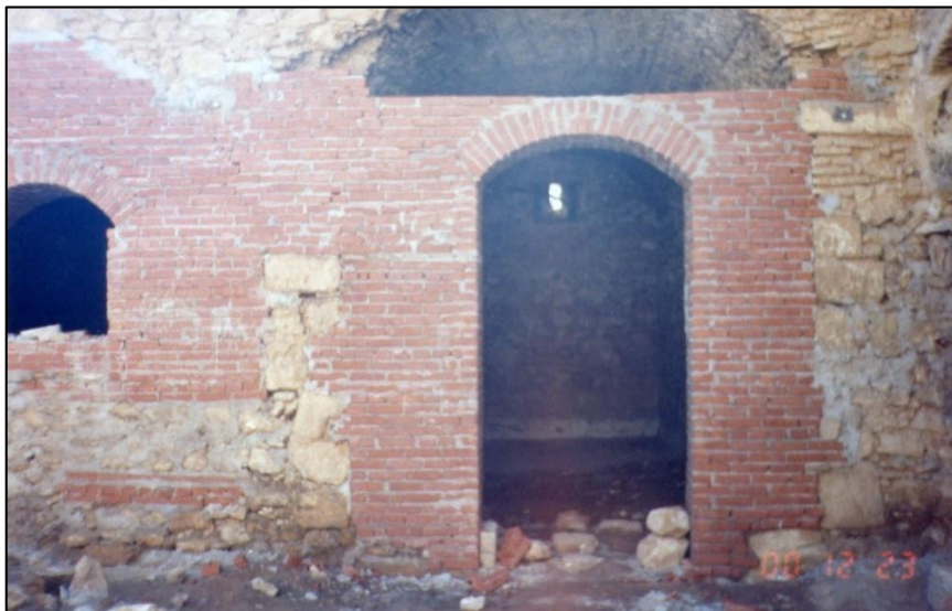
Figure 68 : l'utilisation du béton, du ciment batard, la peinture, la brique plaines / source : photo prise par le bureau d'étude ARTEC
