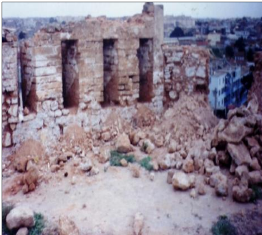
Figure 52 : photo sur la terrasse côté sud, mur extérieur détruit Source : Photo prise par le bureau d'étude ARTEC Source : Photo prise par le bureau d'étude ARTEC
