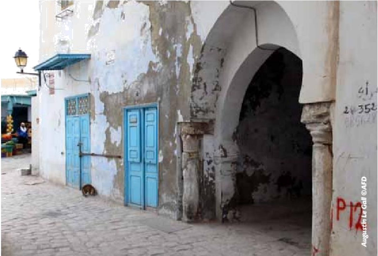
Figure 4 Quartier ancien dégradé de la ville formelle Médina de Kairouan (Tunisie) .Source : Agence Française de Développement (novembre 2014), Intégrer les quartiers précaires aux villes : le défi de demain, Question De Développement Synthèse des études et recherches de l'AFD, Ferrari / elm ,p8.
