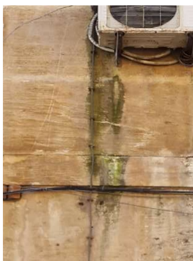
Figure 129 : les traces d'humidité(11). Photo prise décembre 2015
