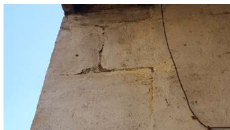
Figure 261 : joint qui endommagé Photo prise décembre 2015
