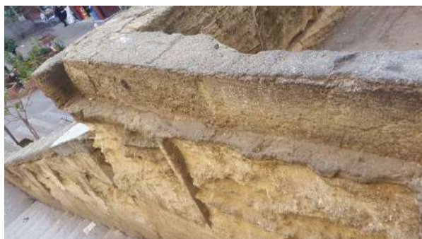
Figure 118 : détérioration du plancher translucide (6). Photo prise décembre 2015
