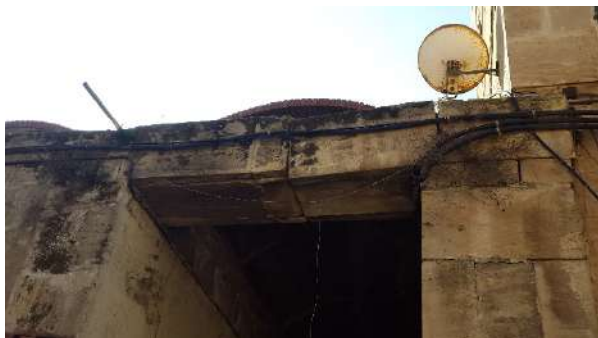
Figure 114 : détachement de pierre banché (1) photo prise décembre 2015
