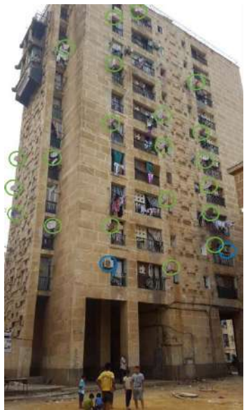
Figure 187 : l’état actuel des façades Sud- Est et Sud- Ouest Photo prise décembre 2015
