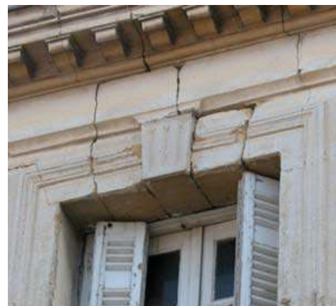
Figure 40 : Les fissures ou lézardes Source : (JB Blom, Caroline Fogliani & DAC, Avril 2009)
