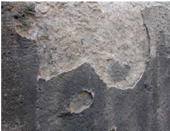
Figure 39 : Le sulfin empêche la pierre de respirer et se détache par plaques, laissant apparaître les pierres altérées par l'humidité. Source : (JB Blom, Caroline Fogliani & DAC, Avril 2009)
