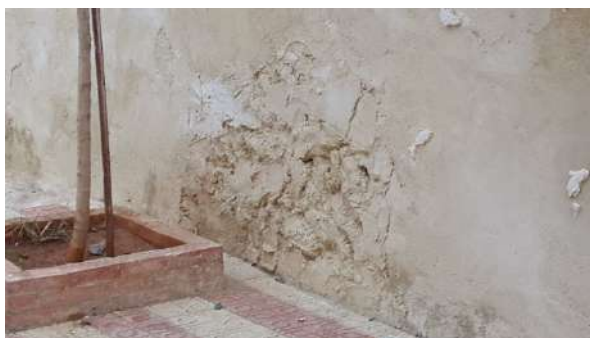
Figure 116 : Une réhabilitation mal faite (3) photo prise décembre 2015
