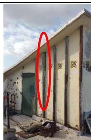
Figure 166 : détachement d'un élément en bois (l'état actuel) Photo prise décembre 2015
