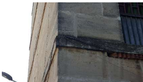
Figure 128 : le sulfure par La pollution apportée par l'eau de pluie(10) Photo prise décembre 2015
