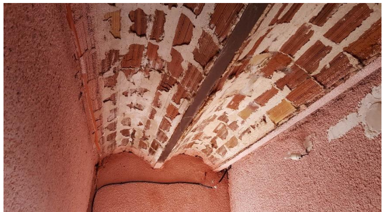
Figure 66: Photo du plancher en voutain de briques pleines du premier niveau de notre cas d'étude (source : auteur).
