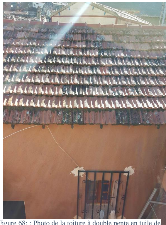
Figure 68: : Photo de la toiture à double pente en tuile de notre cas d'étude, (source : auteur)
