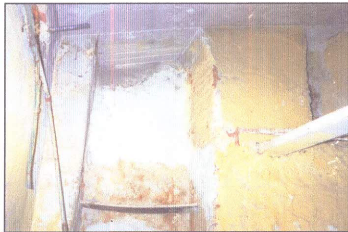
Fig 34 : Dégradation des murs de l'espace dépôt, 2001. Source : Atelier 3D dimensions
