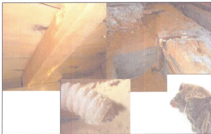
Fig 01: Dégradation de la structure en bois à cause des insectes.
