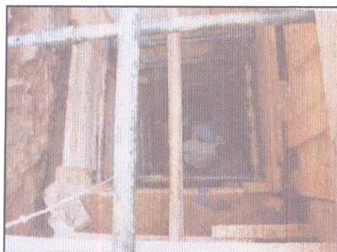
Fig 70 : Reprises-en sous œuvre du minaret : Plot réalisé sous le minaret avec blindage. Source : La DARQ
