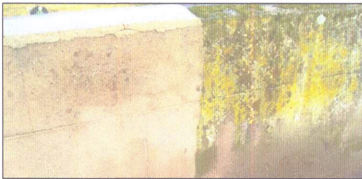
Fig 08 : Le développement d'algues sur les murs en pierre à cause de la présence d'humidité. Source : http://bricolage.linternaute.com/forum/affich-7917-nettoyage-d-une-terrasse , Décembre 2015
