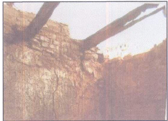
Fig94 : Ossature du plancher haut de la fontaine en IPE rouillés, 2003. Source : La DARQ
