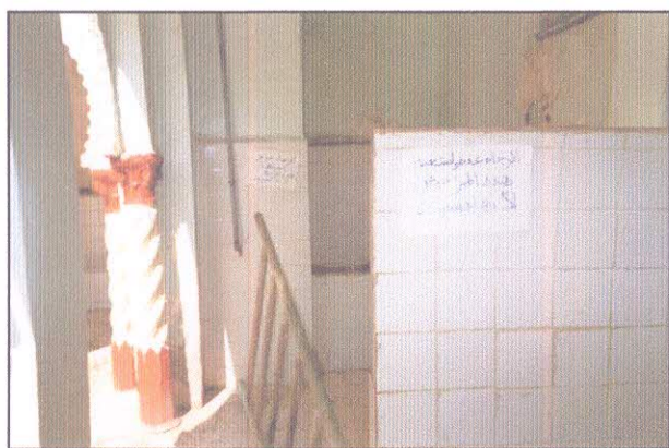
Fig 28 : L'accès aux sanitaires, la dégradation des murs, 2001. Source : Atelier 3D dimensions
