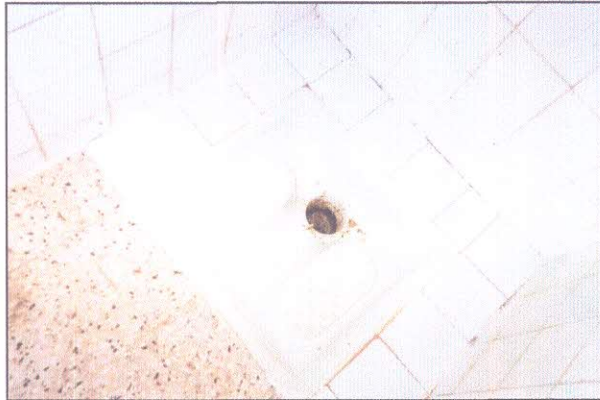
Fig 32 : W.C turque complètement obstrué, 2001. Source : Atelier 3D dimensions
