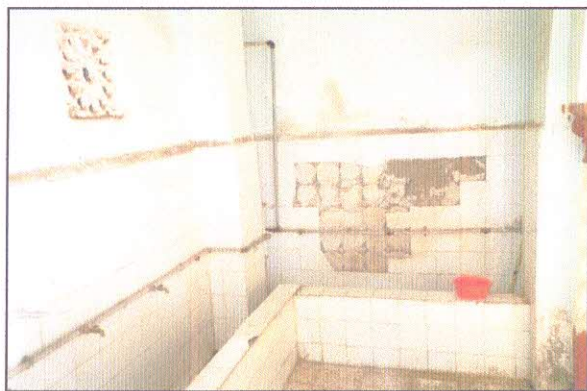
Fig 30 : Le décollement de carreaux de faïence sur murs, 2001. Source : Atelier 3D dimensions
