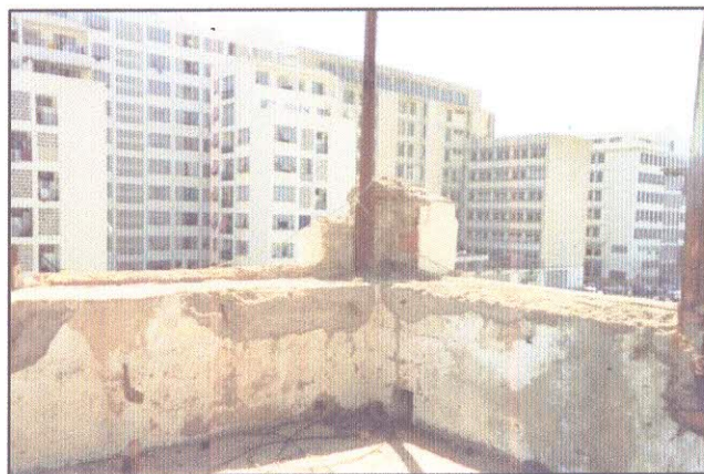
Fig 39 : Dégradation du haut du minaret, 2001. Source : Atelier 3D dimensions
