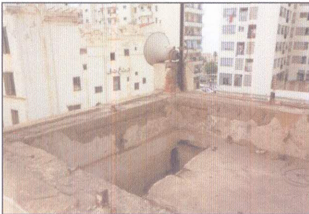
Fig 40 : Terrasse du minaret, dégradation des murs, 2001. Source : Atelier 3D dimensions
