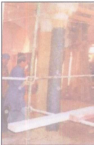
Fig 62 : Étaitement de type chevalement avant restitution d'un chapiteau détérioré, 2003. Source : La DARQ
