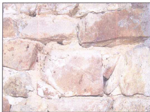
Fig 11 : Jointement des blocs mal fait provoque l'apparition des fissures Source : Caroline, 2009.
