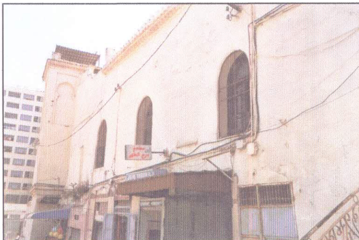
Fig 36 : Les fissures visibles de la façade Nord, 2001. Source : Atelier 3D dimensions
