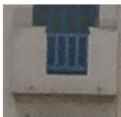
Fig.141: Garde-corps en maçonnerie entrecoupée de barreaux en bois. Source : Photo de l'auteur.
