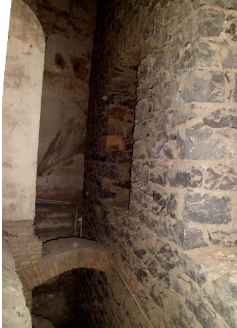
Photo 28: Vide entre l'ancienne maçonnerie et celle du Palais du Bey. (Source : Auteur 2013)
